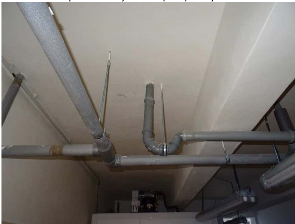
Obrázek 29 – Trubní sifon kanalizace – školní jídelna – dobrý stav
