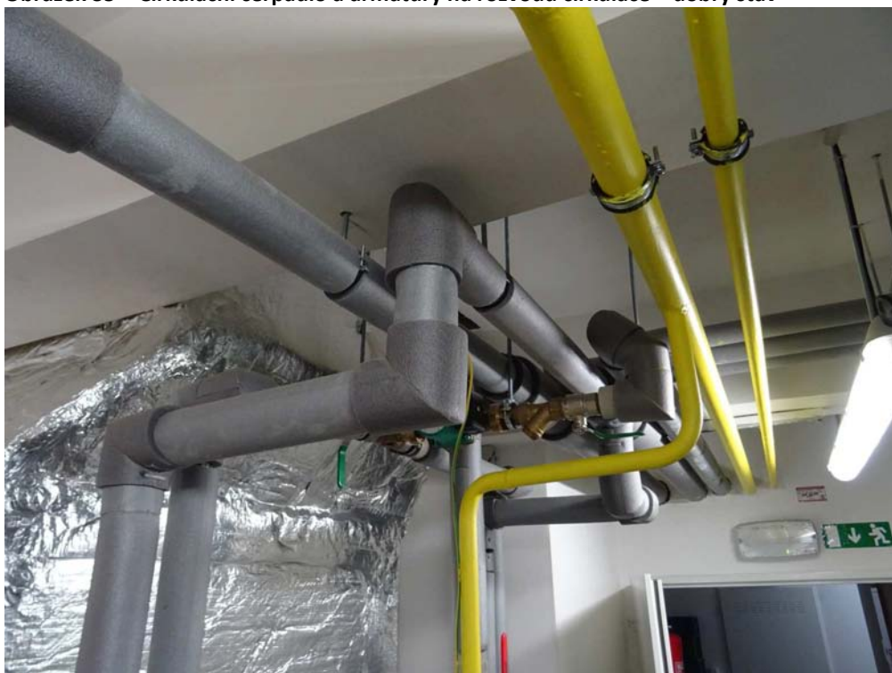
Obrázek 36 – Izolované rozvody vody a rozvod plynu v techn. místnosti – dobrý stav
