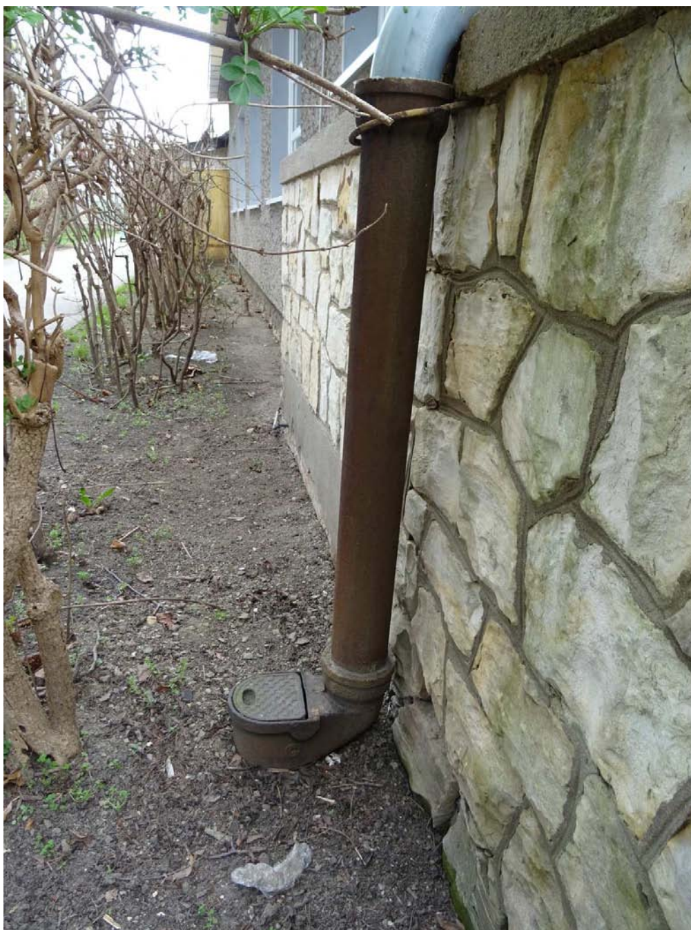
Obrázek 5 – Litinový lapač střešních splavenin – udržovaný stav
