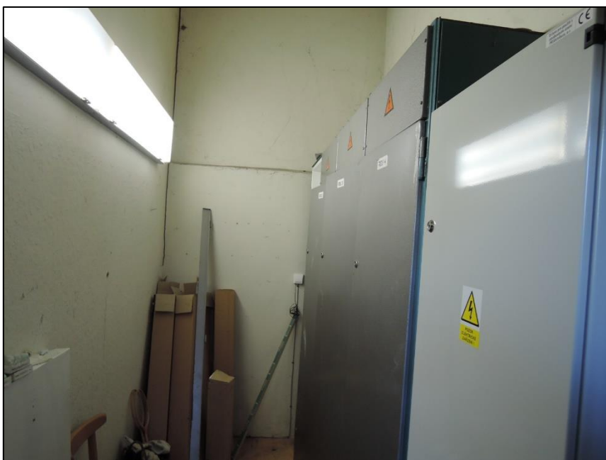
Foto č. 2 – Rozvodna hlavního rozvaděče
