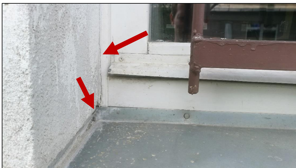
Foto č. 17 – Trhliny, netěsnosti v napojení na okenní konstrukce, na klempířské prvky.
