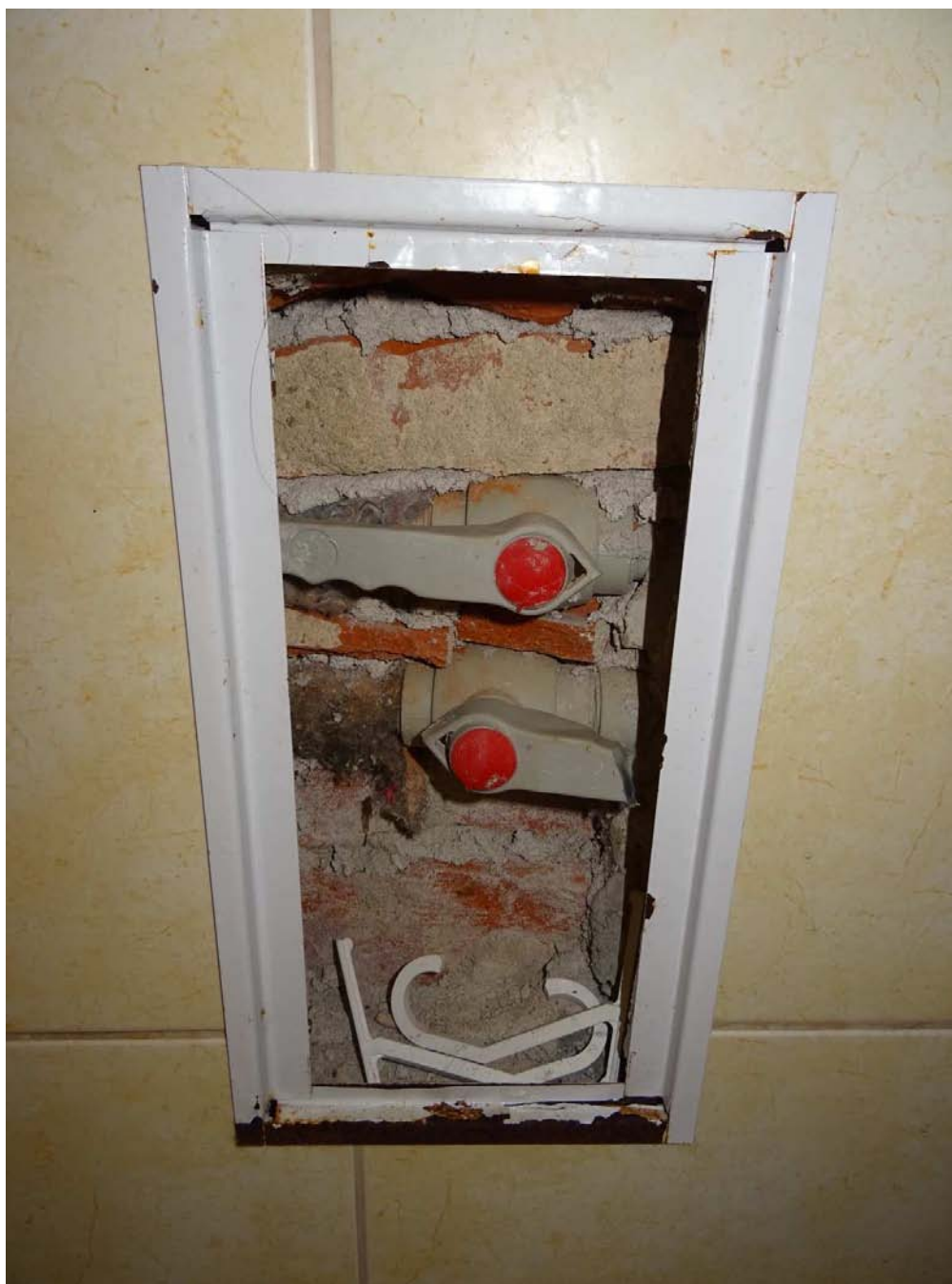
Obrázek 40 – Uzávěry vody na sociálních zařízeních – nedostatečná izolace trubek
