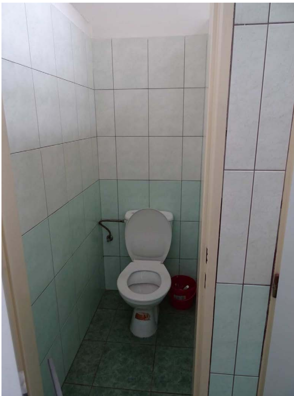
Obrázek 62 – WC – opotřebovaný stav
