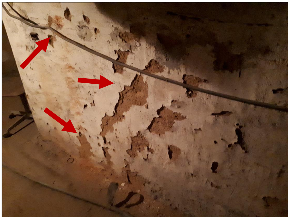
Foto č. 20 – Opadávající omítka stěn podzemního kolektoru pod chodbami – puchýře, sprašování, zvýšená vlhkost, odlupování.
