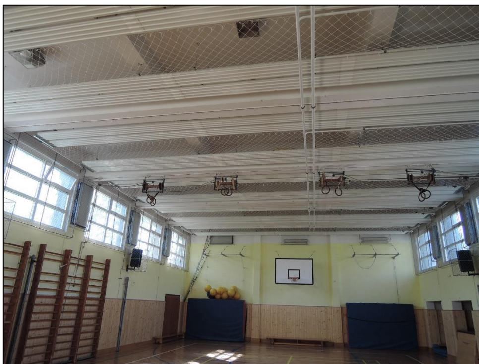
Foto č. 12 – Osvětlení v tělocvičně
