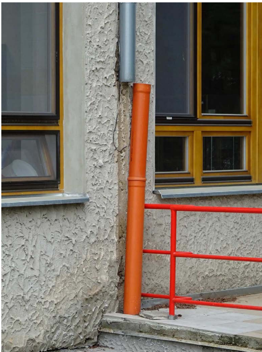
Obrázek 65 – Špatné propojení pozinkovaného svodu a PVC-KG trubky – špatný stav
