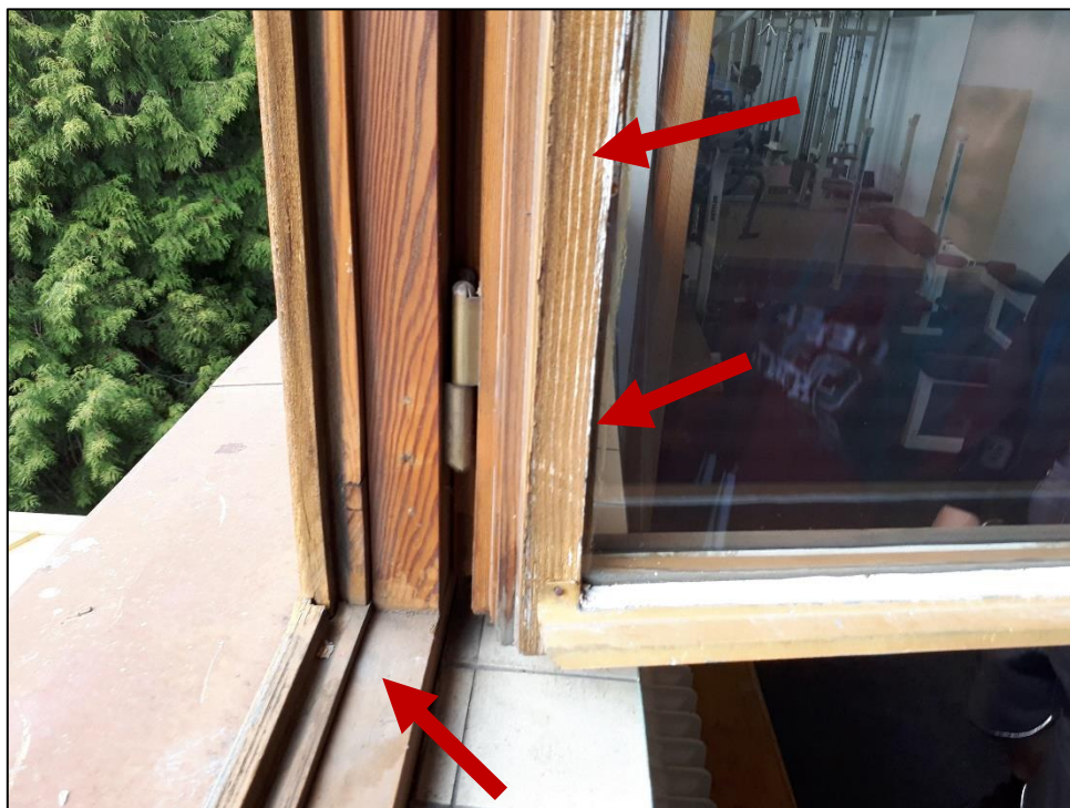
Foto č. 36 – Dtto Foto č. 34, dožilé zasklívací tmely, ochranný nátěr dřevěných křídel a rámu – postupná degradace.
