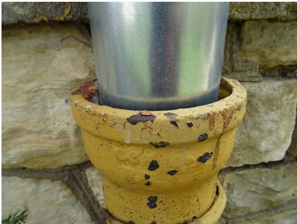
Obrázek 2 - Litinový dešťový svod – jemná koroze hrdla – špatný stav
