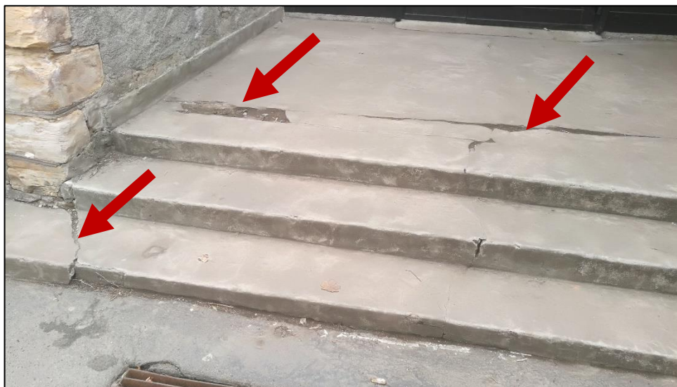
Foto č. 54 – Degradace betonových schodišť – vypadávání betonu, velké trhliny, schody nejsou v jednotném spádu.
