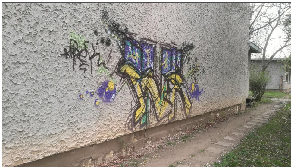
Foto č. 14 – Lokální opravy kamenné vyzdívky soklu, graffiti na štitové stěně.
