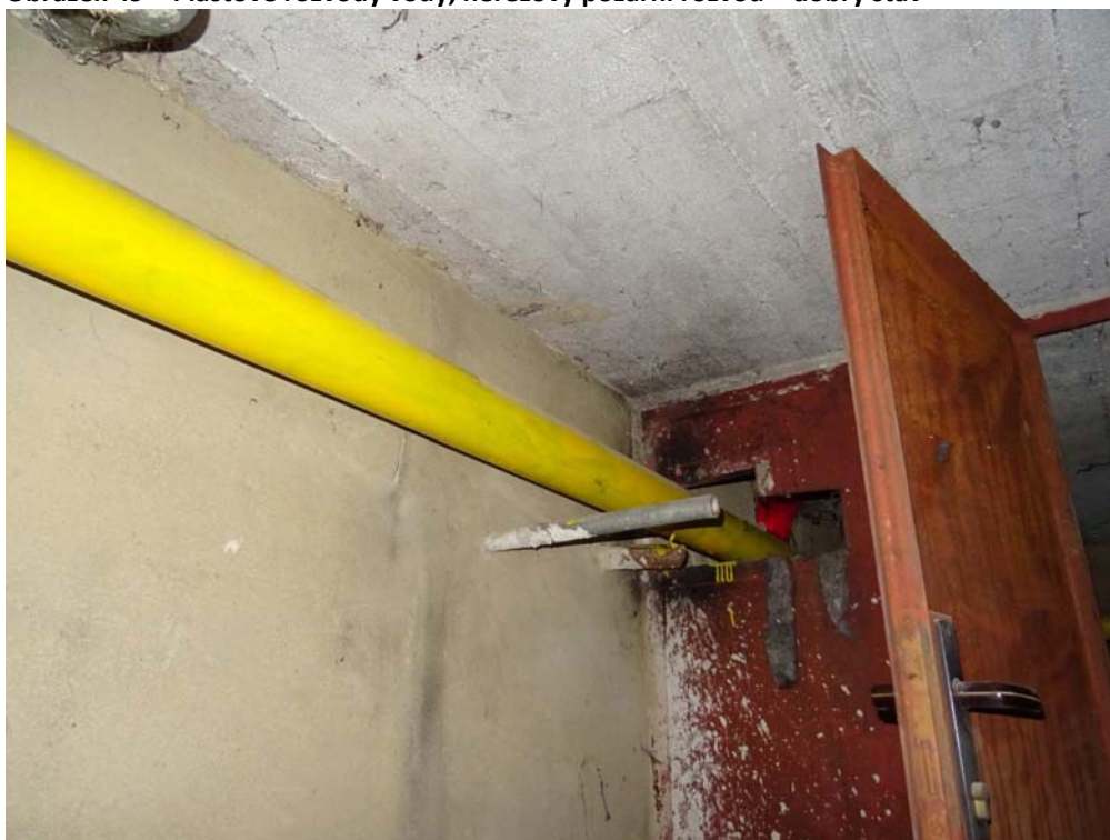
Obrázek 50 – Rozvod plynu v kolektoru – dobrý stav
