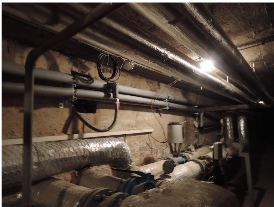
Foto č.16 – kabelový rozvod výměníku
