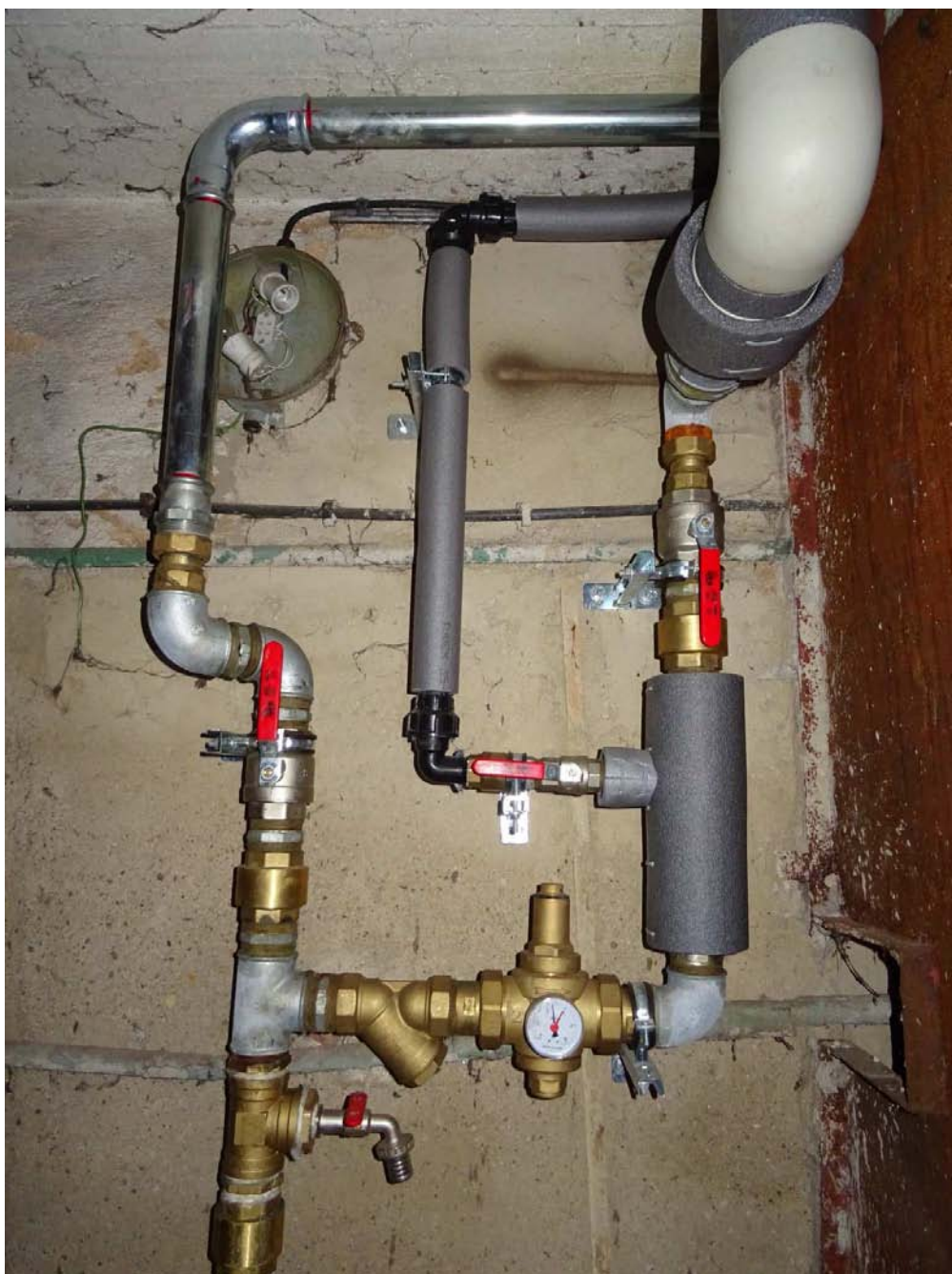
Obrázek 51 – Rozdělení vodovodu na požární rozvod a rozvod pitné vody – chybí kontrolovatelná zpětná armatura na požárním vodovodu, jinak dobrý stav
