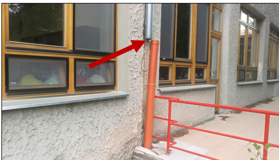
Foto č. 47 – Netěsné napojení svislých svodů se objevuje na více místech – zvýšené namáhání okolní omítky tekoucí vodou.
