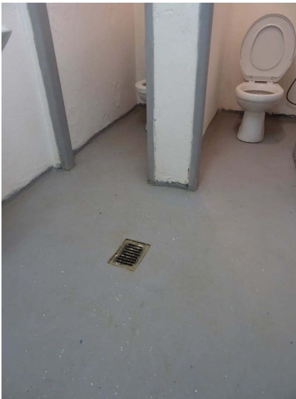
Obrázek 18 – Sociální zařízení – opotřebovaný stav, znečištěná podlahová vpust (v krytu)
