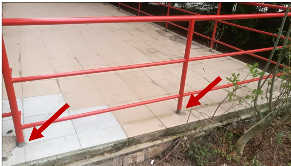
Foto č. 51 – Zábradlí terasy – nevhodné kotvení shora – dlouhodobě nefunkční detail napojení hydroizolace – vysoké riziko zatékání.
