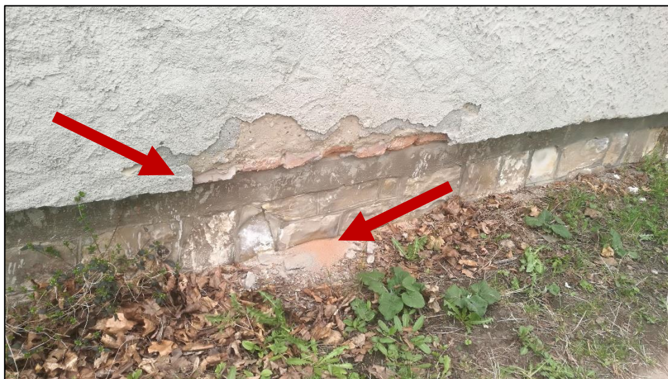
Foto č. 10 – Omítka u soklu zvětralá, odlupuje se. Narušení kamenné přizdívky soklu.
