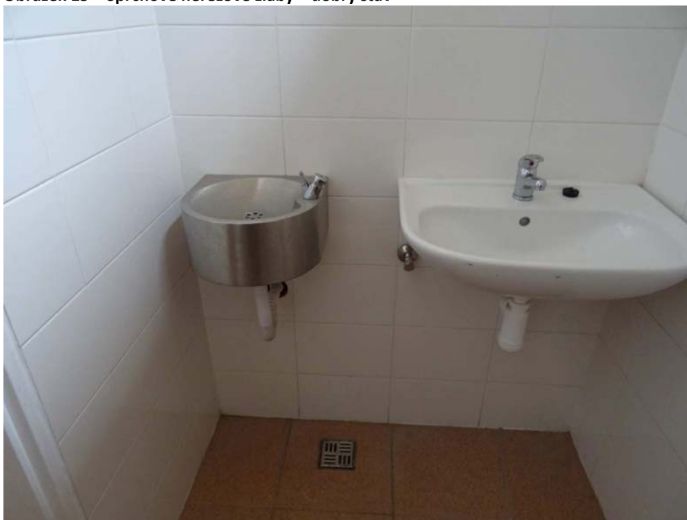
Obrázek 16 – Umyvadlo, umývatko, nerez vpust – dobrý stav
