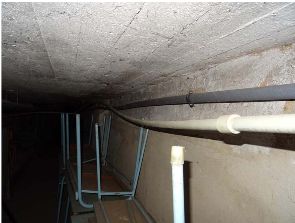
Obrázek 41 – Průhyby rozvodů vody v kolektoru, bez izolace – špatný stav
