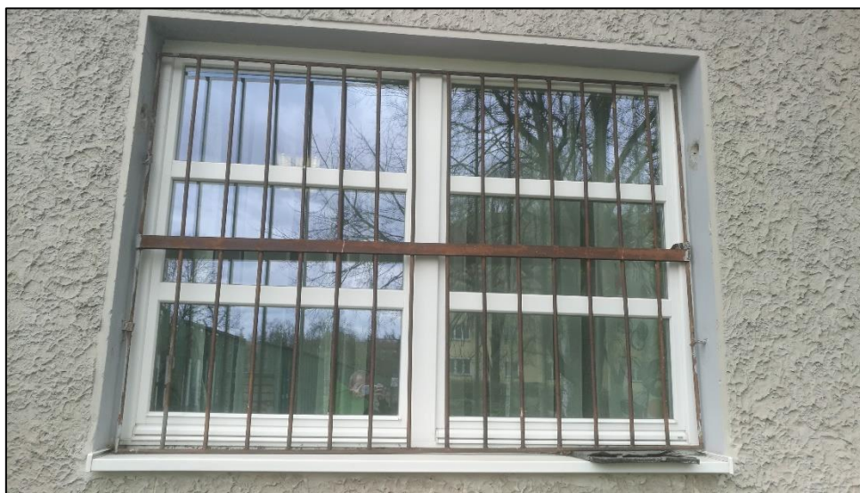
Foto č. 48 – Kovové mříže na oknech – dožilý ochranný nátěr, koroze.
