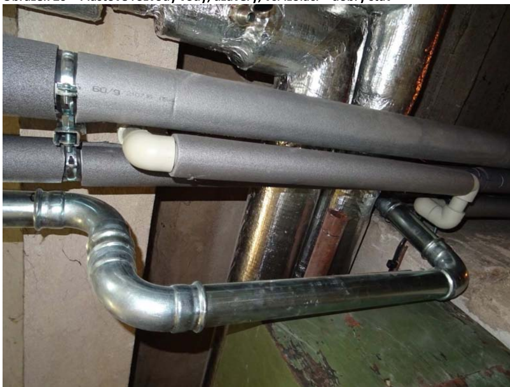
Obrázek 21 – Plastové rozvody vody – bez izolace kolen, nerezový požární rozvod – dobrý stav
