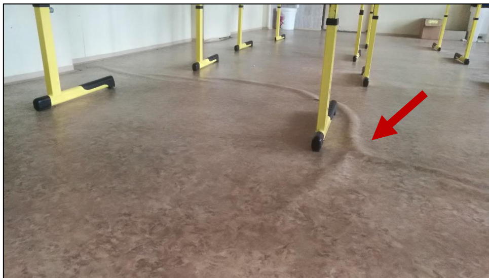
Foto č. 52 – Zvlněná podlahová krytina v některých třídách – dle dostupných informací je pravděpodobné vadné provedení opravy této konstrukce.
