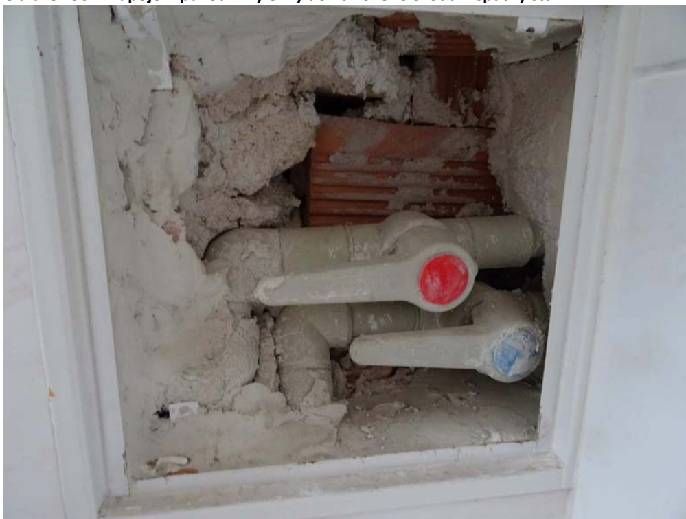
Obrázek 57 – Uzávěry vody v revizním otvoru – chybí izolace
