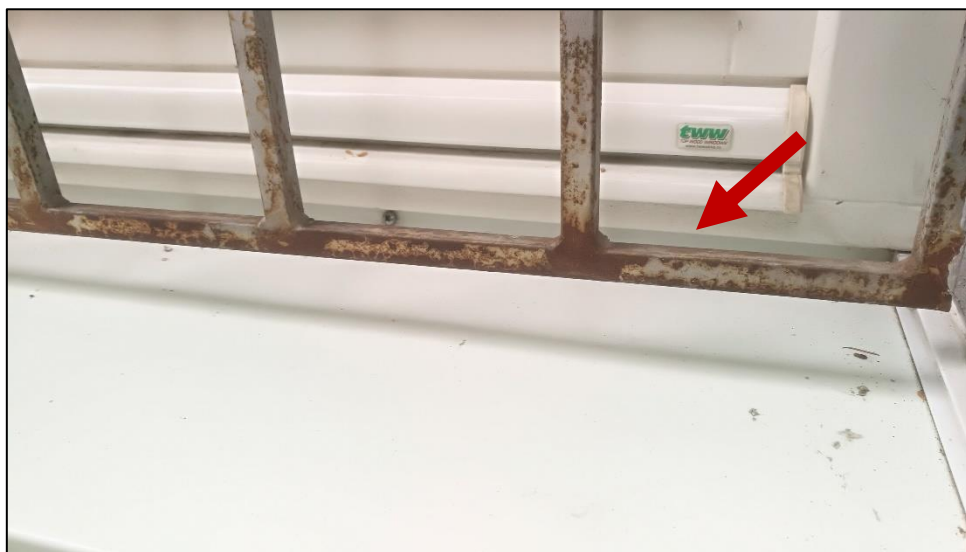
Foto č. 49 – Dtto Foto č. 48 – dožilý ochranný nátěr, koroze mříží.
