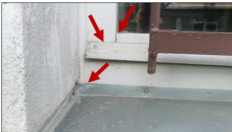
Foto č. 32 – Dtto Foto č. 31, netěsné napojení na oplechování parapetu, na okenní ostění – riziko zatékání do konstrukce, interiéru a další degradace dřevěných oken.
