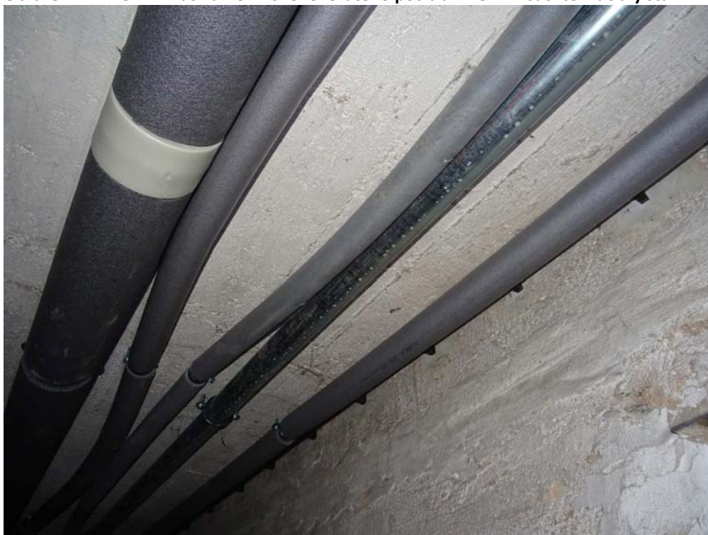
Obrázek 48 – Rozvody vody pod stropem kolektoru – průhyby trubek, špatné uchycení
