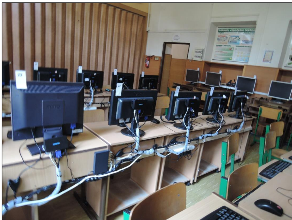
Foto č. 24 – slaboproudé rozvody v PC učebně
