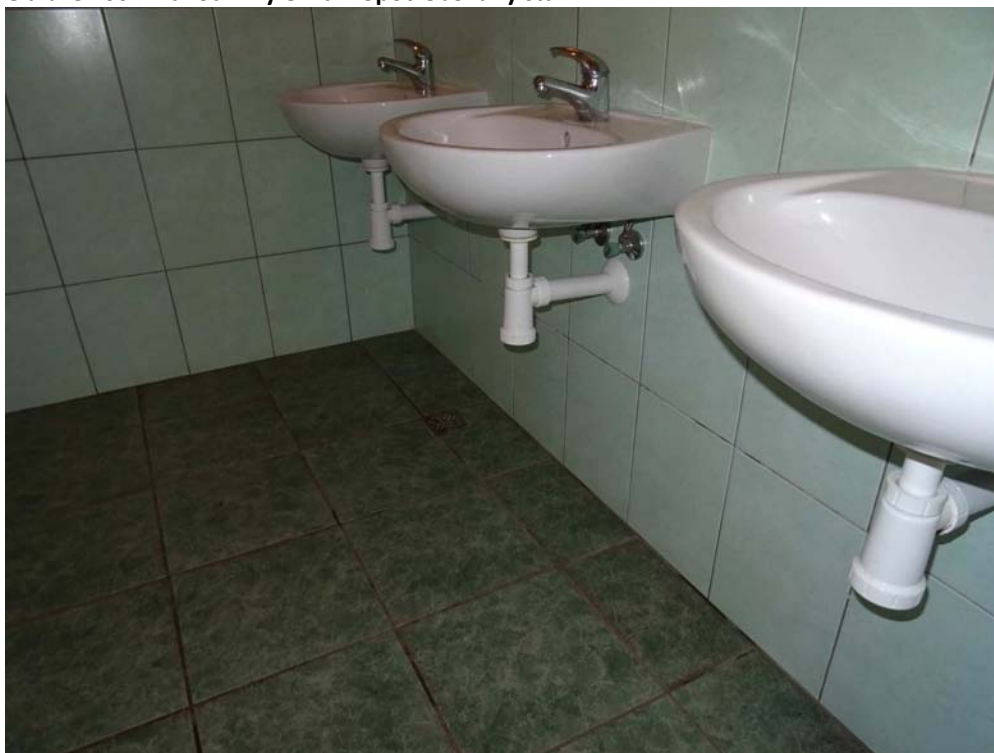
Obrázek 61 – Umyvadla – opotřebovaný stav
