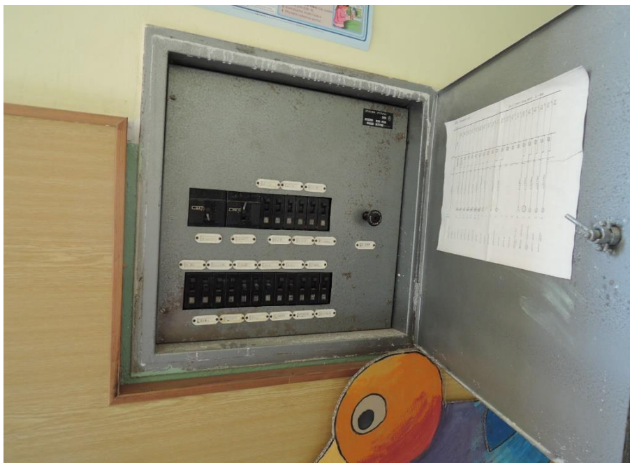
Foto č.5 – patrové rozvaděče
