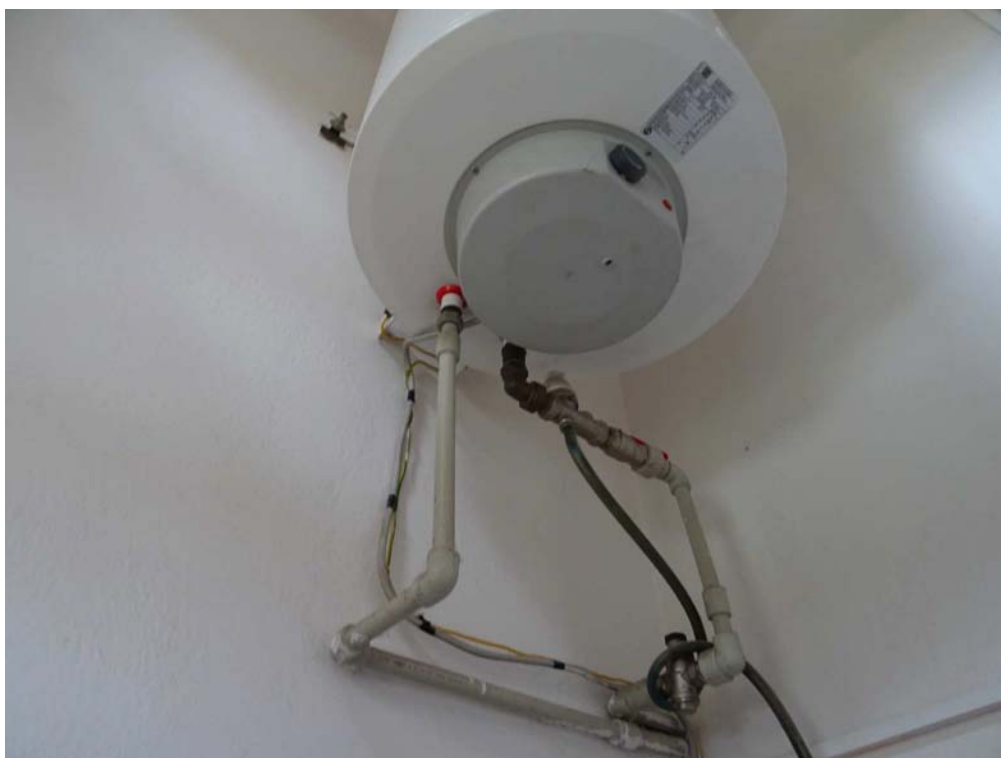
Obrázek 11 – Napojení elektrického zásobníkového ohřívače vody – dobrý stav
