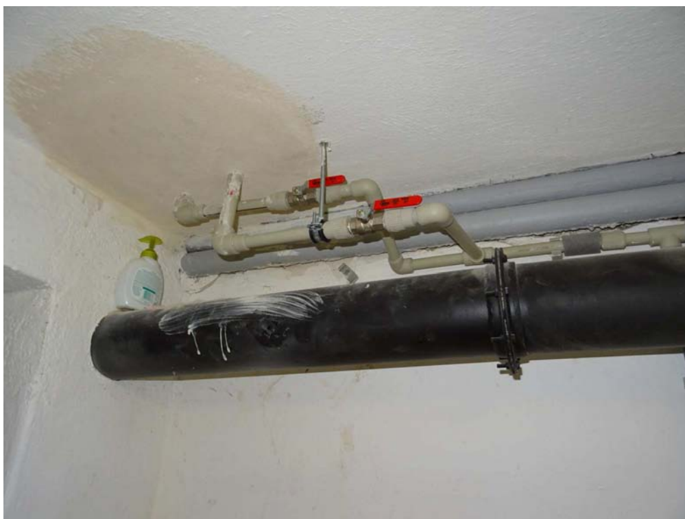
Obrázek 22 – Ležaté rozvody vody pod stropem krytu – chybí izolace
