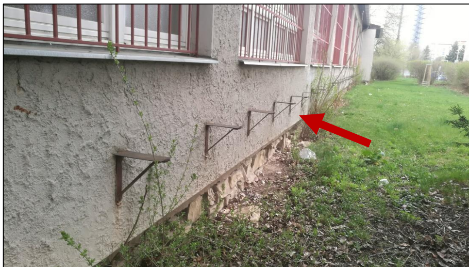
Foto č. 50 – Konzoly na fasádě – koroze, mechanické poškození.
