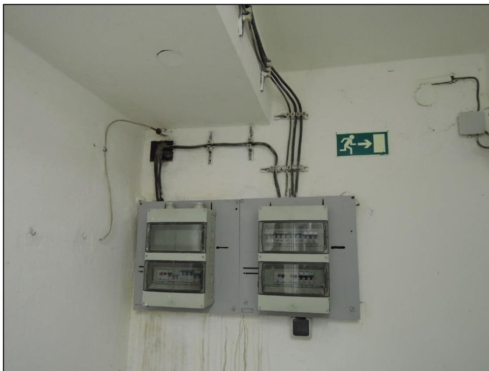
Foto č. 17 – Rozvaděč v technických prostorách
