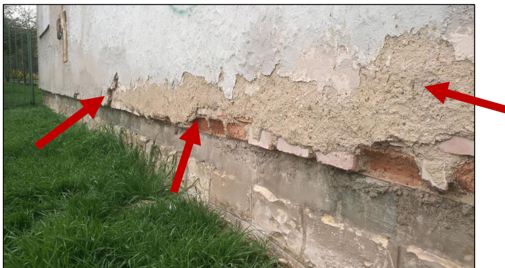
Foto č. 11 – Dtto Foto č. 10 – zvětralá omítka, spráskuje, dutiny, odpadávání omítky. Mechanické poškození cihelného zdiva. Absence účinného okapového chodníku.
