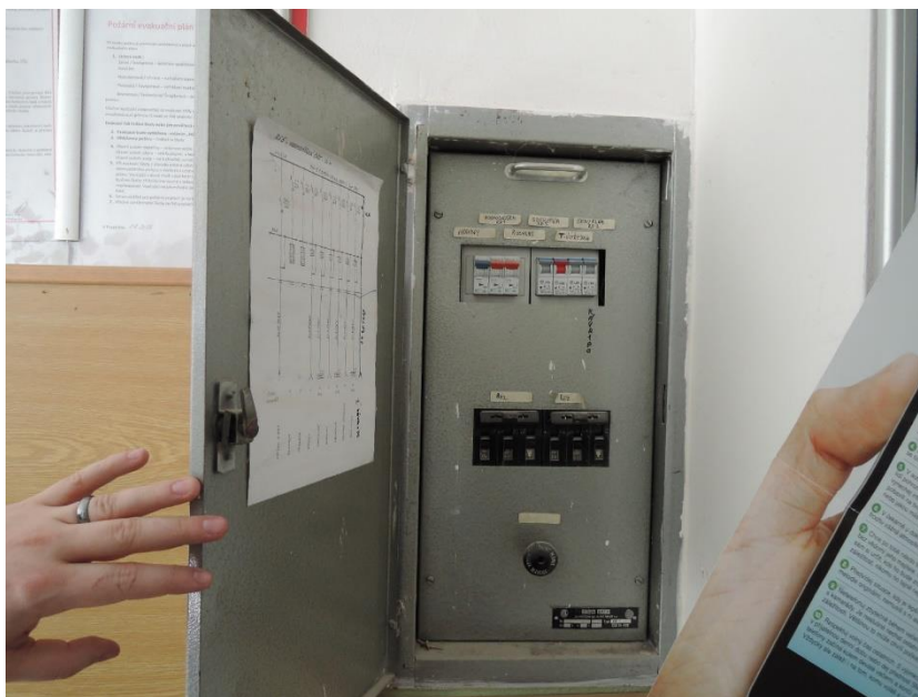
Foto č.7 – podružný rozvaděč
