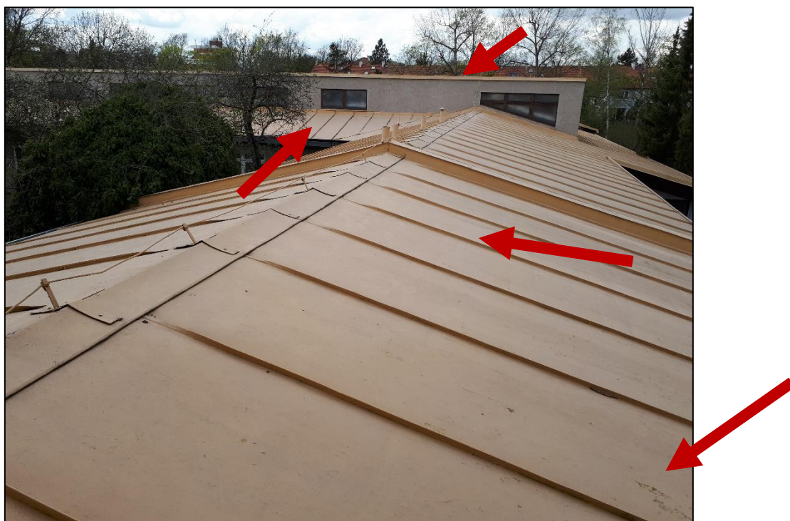
Foto č. 21 – Pohled na sedlovou plechovou střechu spojovací chodby, v pozadí pultové střechy objektu učeben. Lokální odlupování ochranného nátěru.
