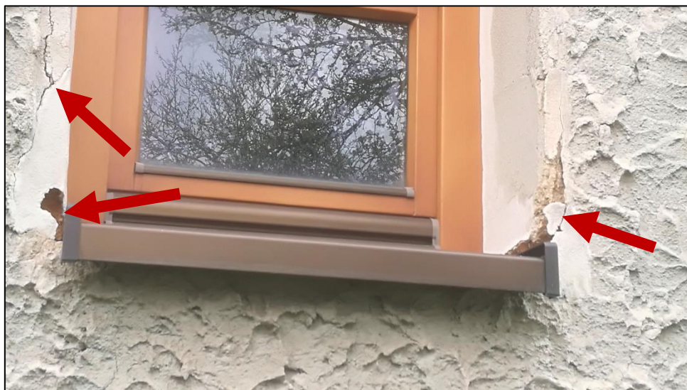
Foto č. 16 – Odpadávání omítky, výrazné trhliny v detailech napojení na oplechování parapetů - netěsnosti.
