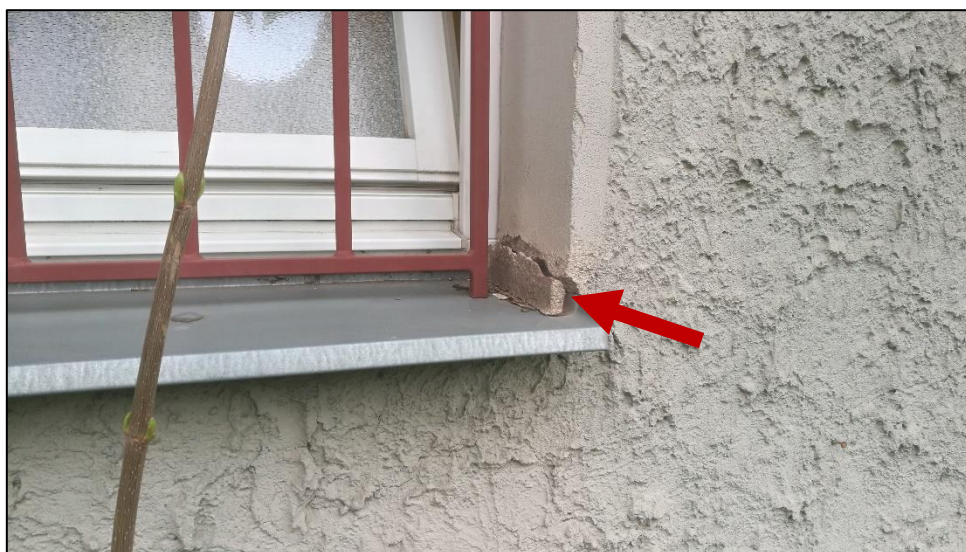
Foto č. 15 – Odpadávání omítky, trhliny v detailech napojení na oplechování parapetů.
