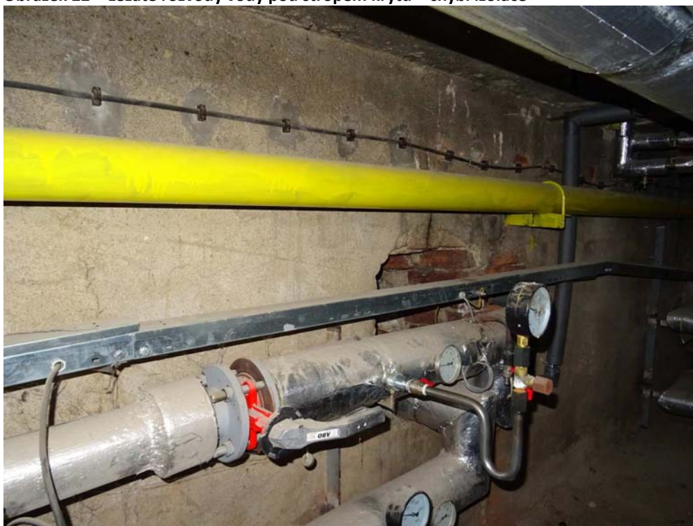
Obrázek 23 – Plynový rozvod – dobrý stav
