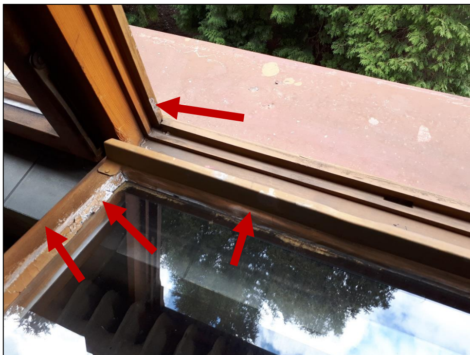
Foto č. 35 – Dřevěná okna s poškozenými tmely a nátěry – postupná degradace.
