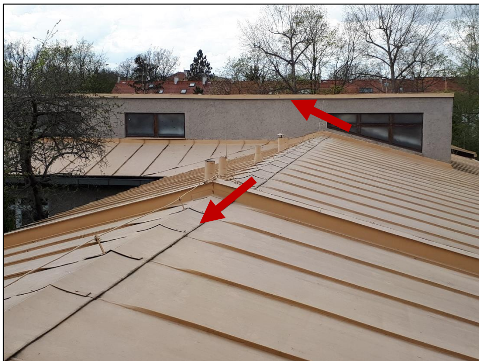
Foto č. 22 – Nedostatečně dimenzované větrací otvory plechové střechy.
