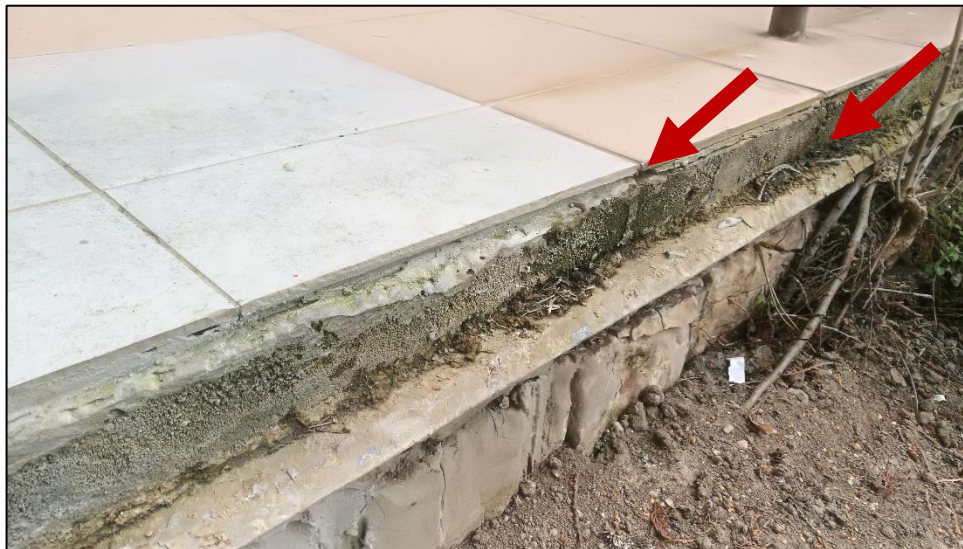
Foto č. 53 – Nevhodná skladba terasy u kuchyně – dlouhodobě nefunkční – akumulace vlhkosti v betonové mazanině a následná separace keramické dlažby podlahy.
