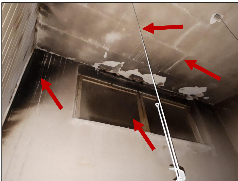
Foto č. 23 – Prostor vazníkové pultové střechy učebnového pavilonu zasaženého požárem – znatelné spáry mezi deskami tepelné izolace. Okno pod střechou je zazděno.
