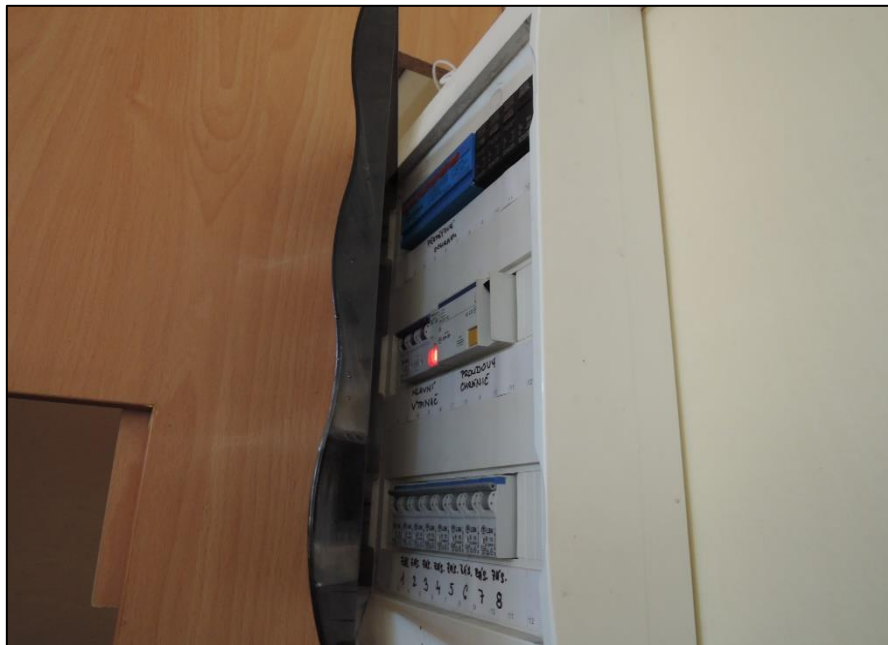
Foto č. 30 – Rozvaděč v PC učebně (nepřístupný)
