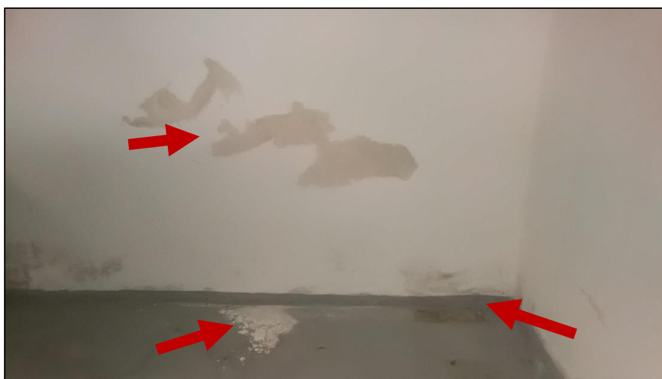
Foto č. 18 – Vlhkostní poruchy, odlupování omítky v krytu CO – část B.
