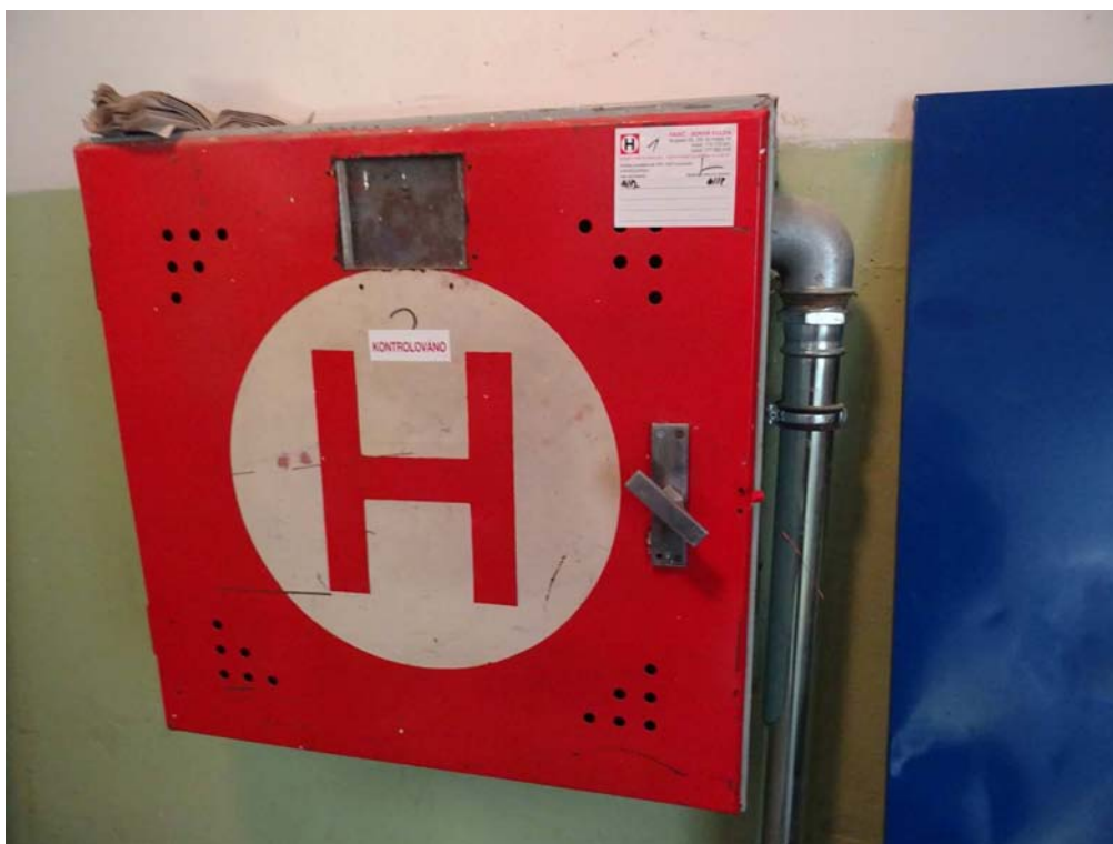
Obrázek 17 – Napojení požárního hydrantu na nerezové požární potrubí – dobrý stav
