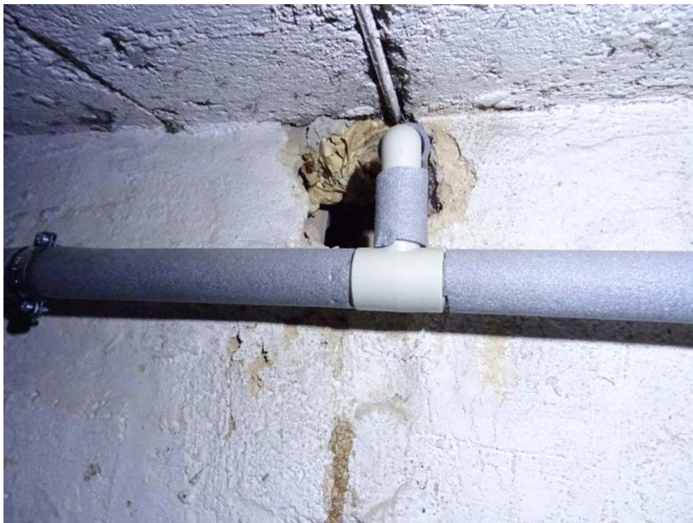
Obrázek 43 – Rozvod vody – chybí izolace kolen
