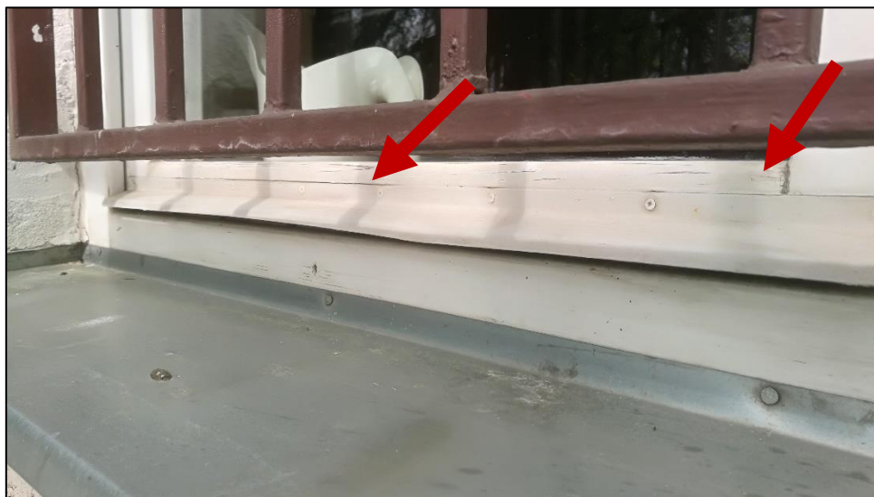
Foto č. 31 – Okna pavilonu IV byla měněna v roce 2003 – poškozen ochranný nátěr, narušena dřevní hmota křídel a rámců, netěsné napojení na okapnice.
