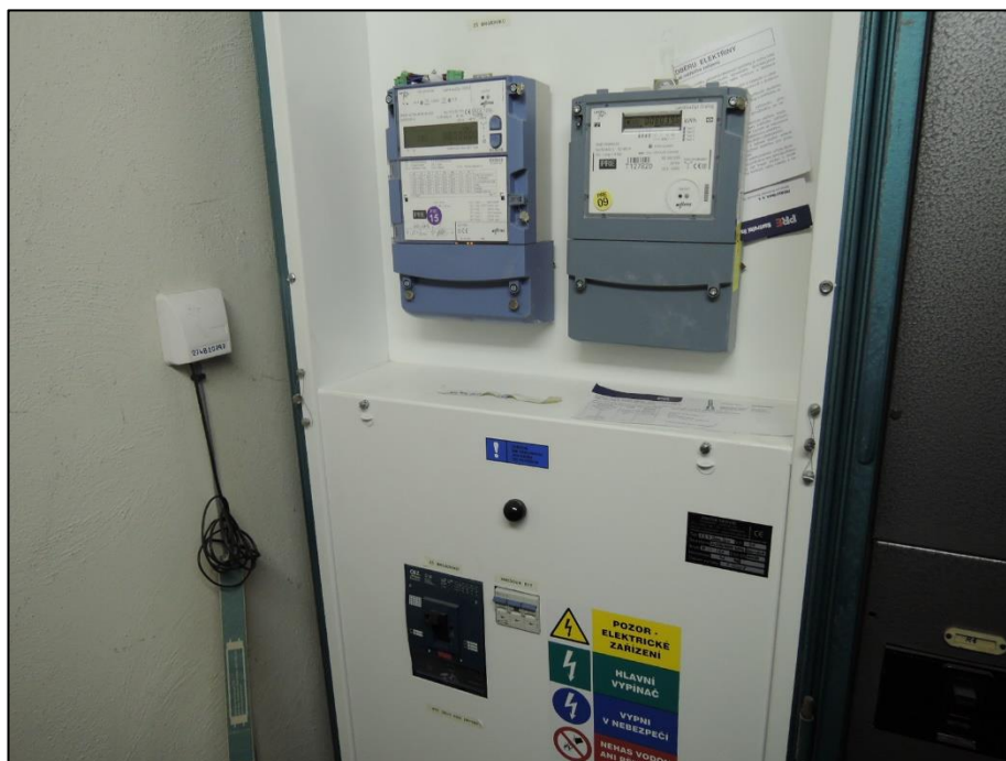
Foto č. 3 – měření odběru v hlavním rozvaděči
