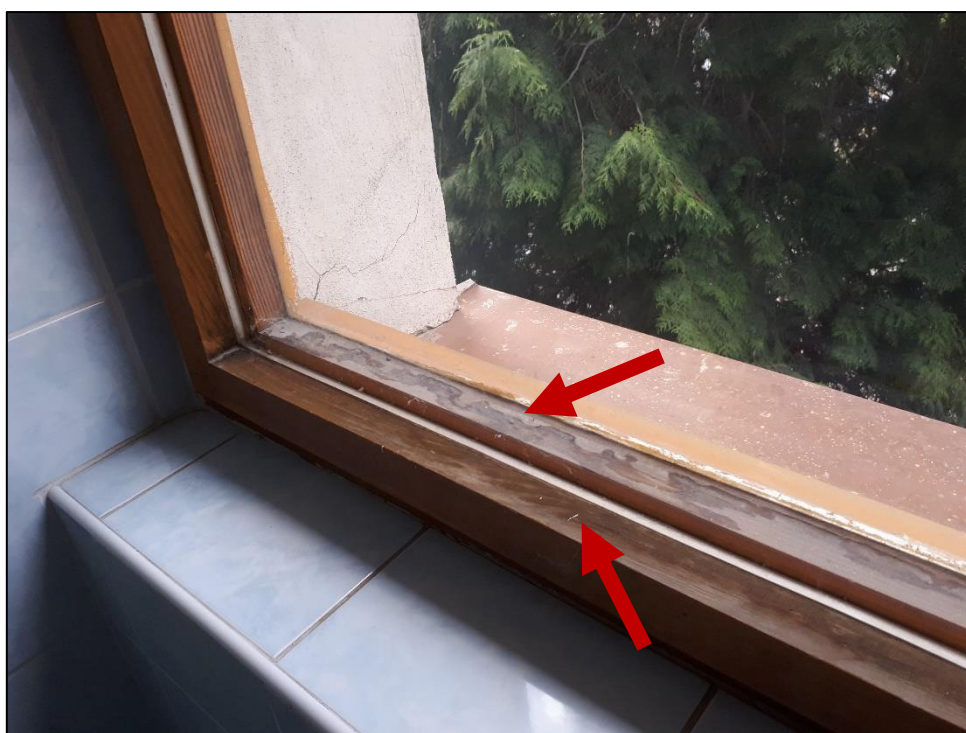
Foto č. 37 – Degradace dřevěných křídel, také v meziskelním prostoru netěsných křídel díky stékajícímu kondenzátu v chladnějším období.
