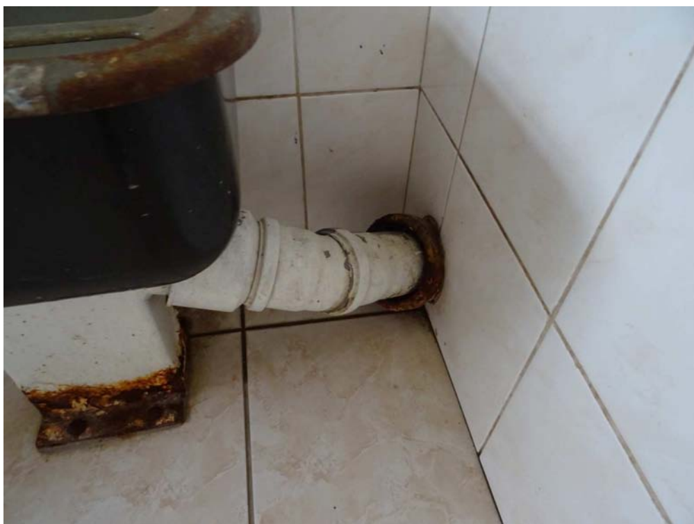
Obrázek 56 – Napojení původní výlevky do litinového svodu – špatný stav
