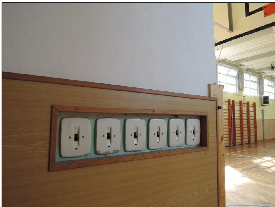
Foto č. 20 – vypínače pro osvětlení tělocvičny
