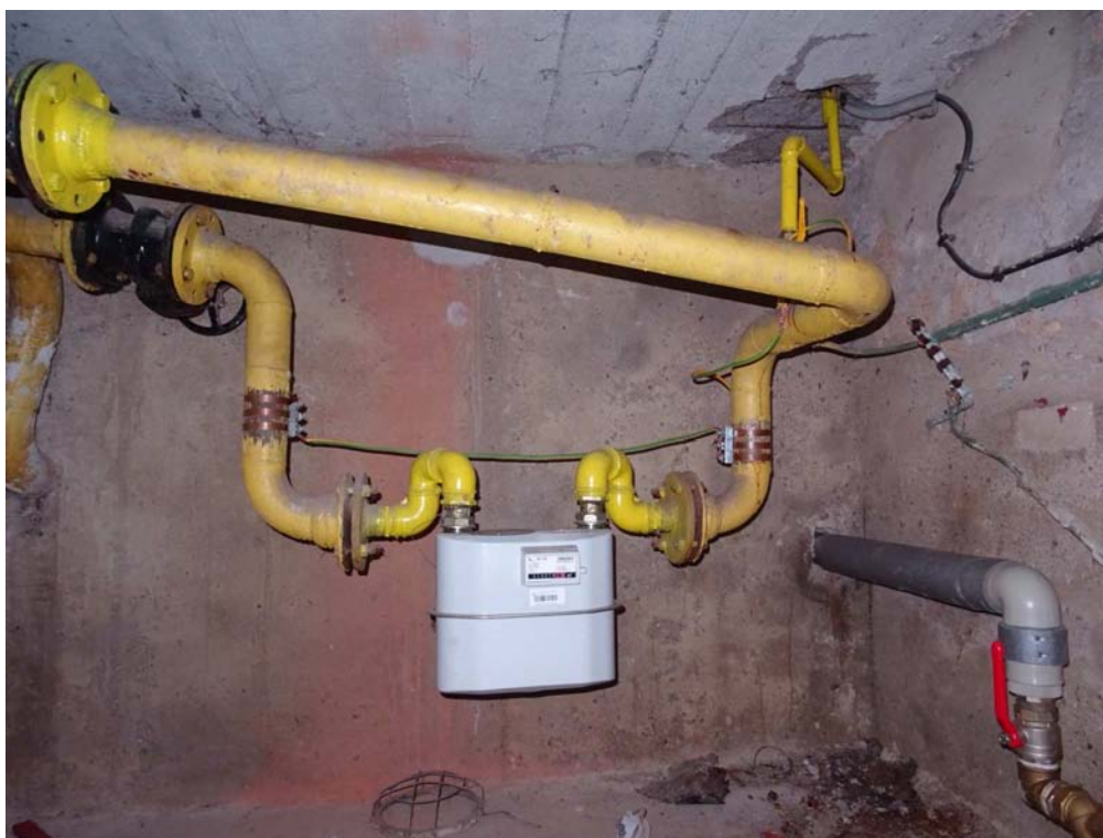
Obrázek 54 – Napojení plynovodu – dobrý stav
