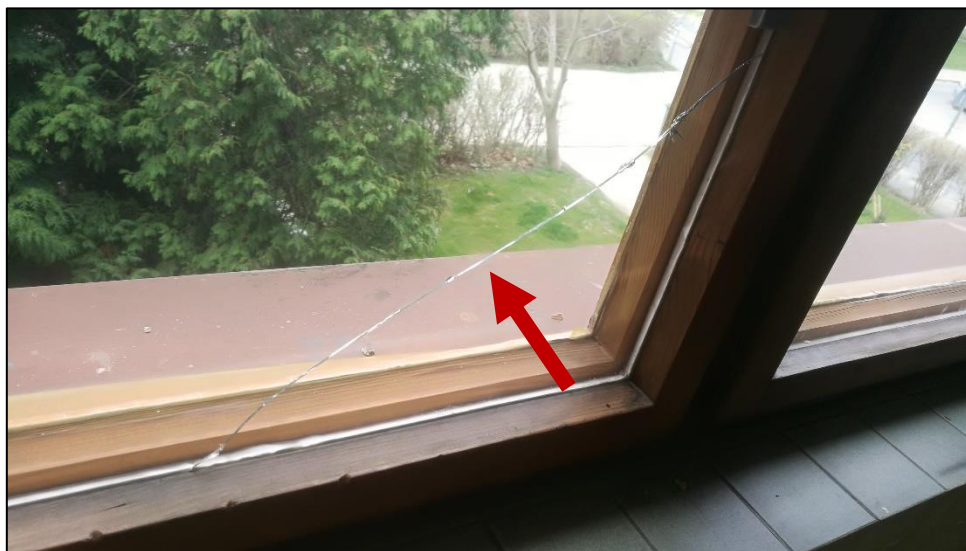
Foto č. 34 – Původní dřevěná zdvojená okna – dílny ve 2.NP hlavní budovy – lokálně poškozeno zasklení.
