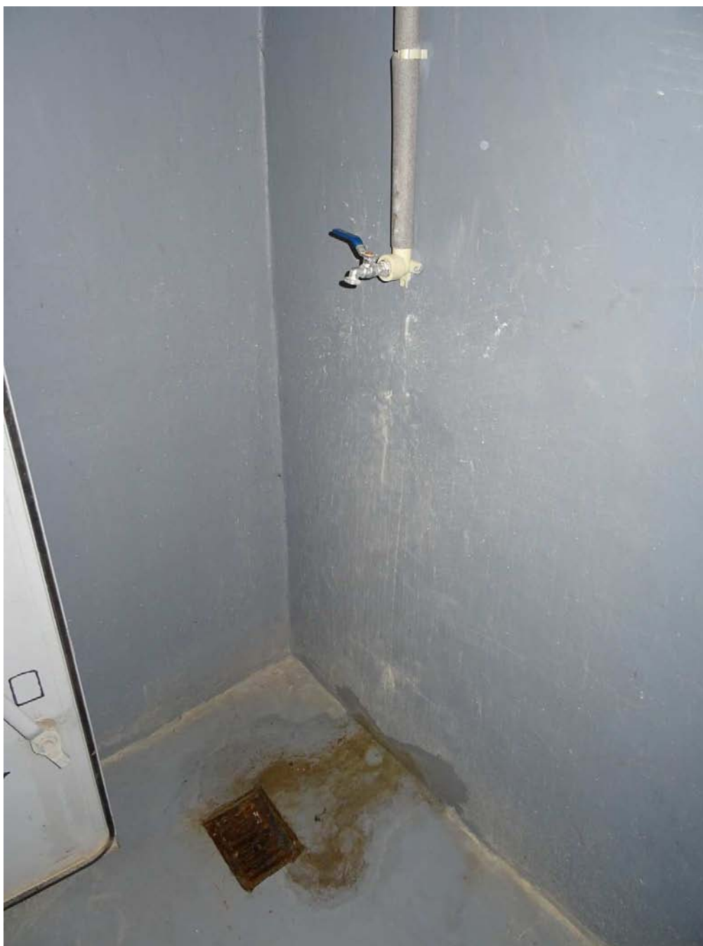
Obrázek 19 – Výtoková baterie, zrezivělá mřížka podlahové vpust (v zemním krytu)
