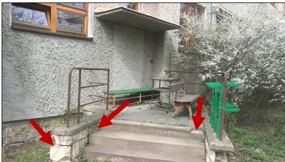
Foto č. 56 – Rozpad vedlejších schodišť a bočních zídek, koroze kovových zábradlí.
