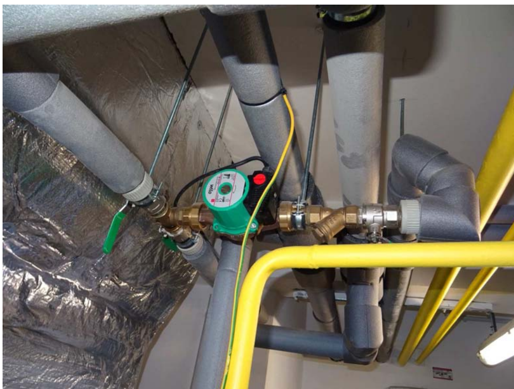
Obrázek 35 – Cirkulační čerpadlo a armatury na rozvodu cirkulace – dobrý stav
