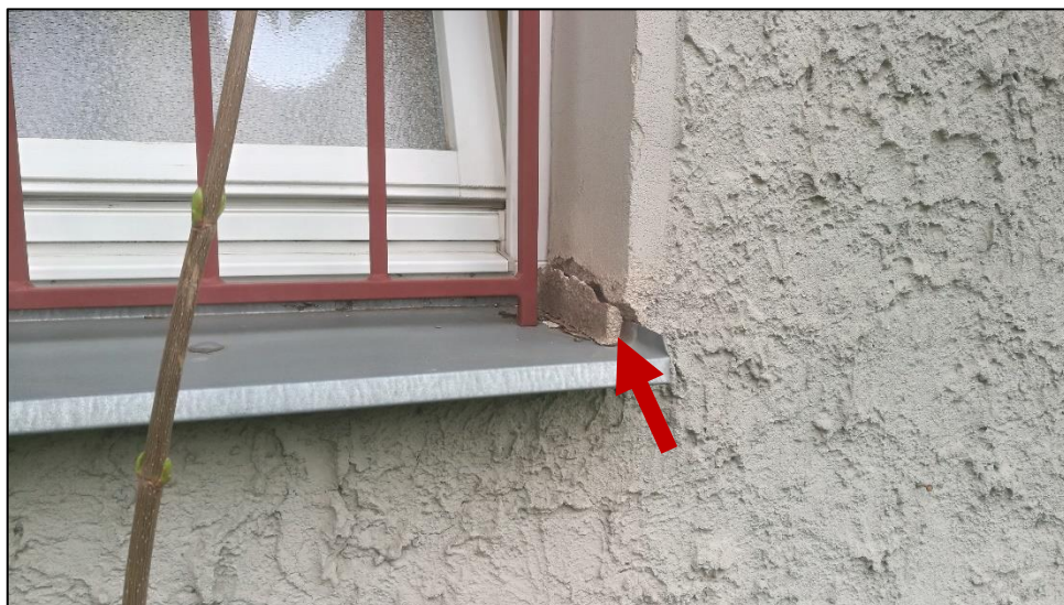
Foto č. 40 – Oplechování parapetů zataženo pod omítku, není umožněna dilatace – odlupování omítky.
