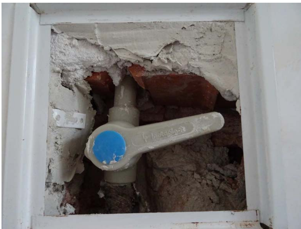
Obrázek 58 – Uzávěr vody v revizním otvoru – dobrý stav
