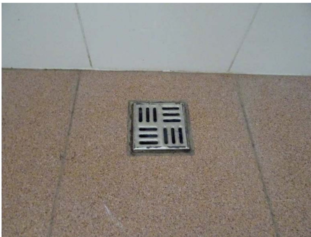
Obrázek 13 – Nerezová vpust na sociálních zařízeních – dobrý stav
