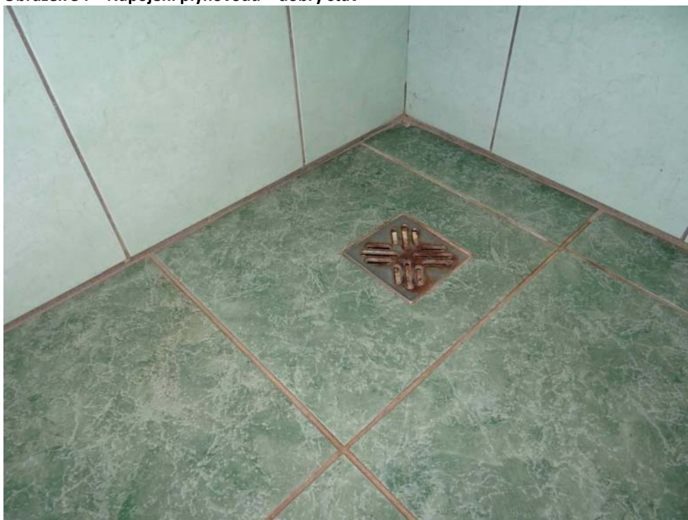
Obrázek 55 – Zrezivělá mřížka podlahové vpusti – špatný stav
