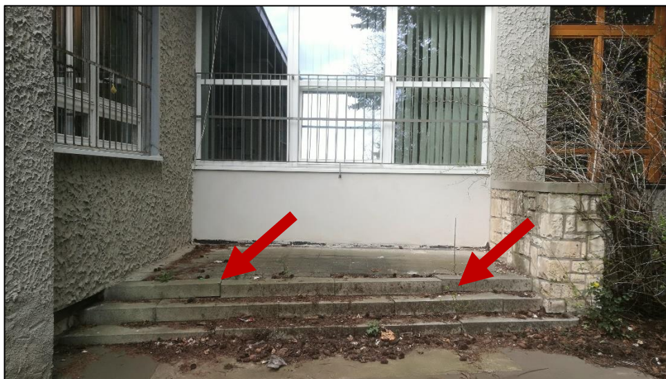
Foto č. 55 – Rozpad vedlejších schodišť.
