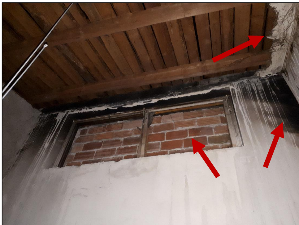
Foto č. 24 – Učebnový pavilon III v místě požáru – nad cca polovinou půdorysu zcela chybí tepelná izolace ve střeše. Okno zazděno.
