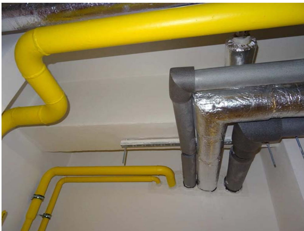
Obrázek 30 – Izolované rozvody vody, plynové rozvody – dobrý stav
