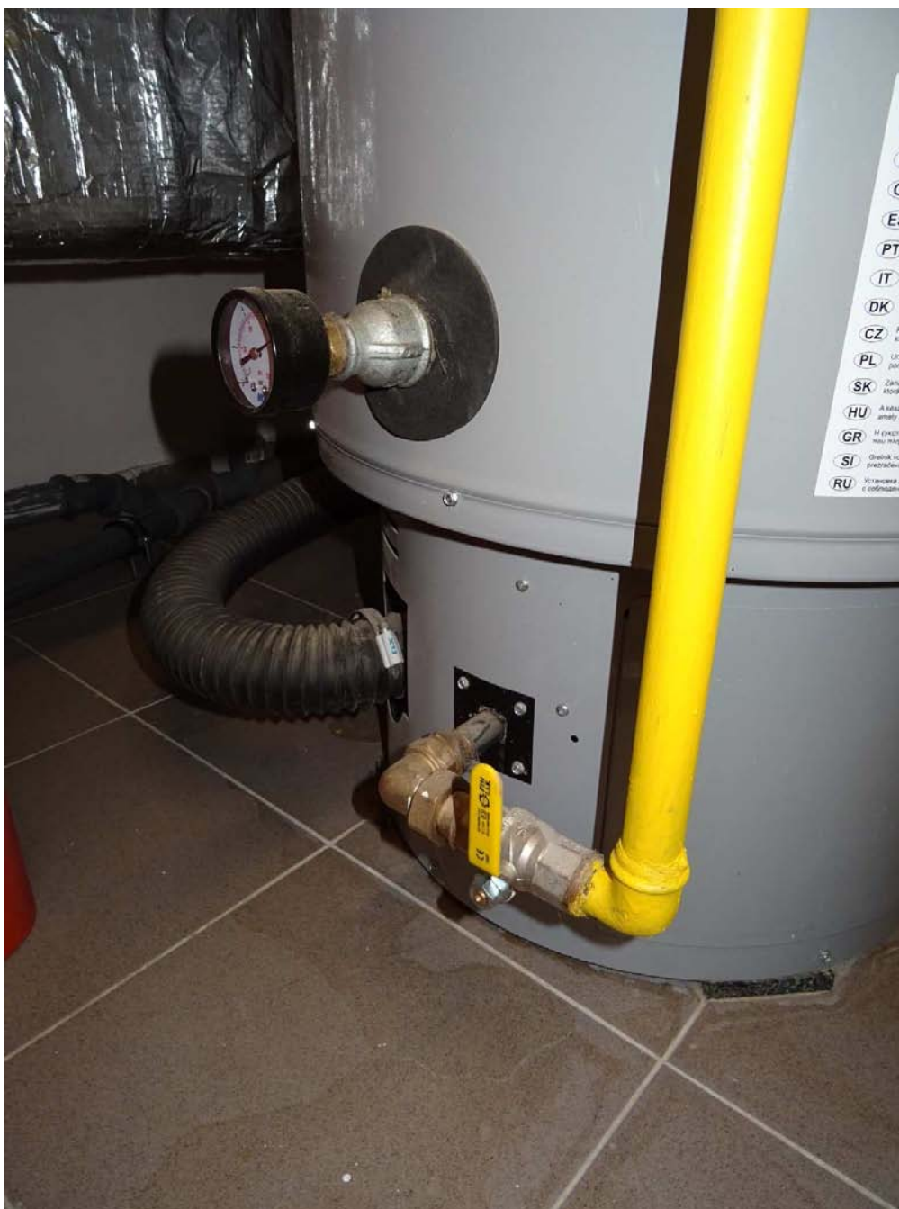
Obrázek 38 – Napojení kondenzačních ohřivačů na plyn – dobrý stav
