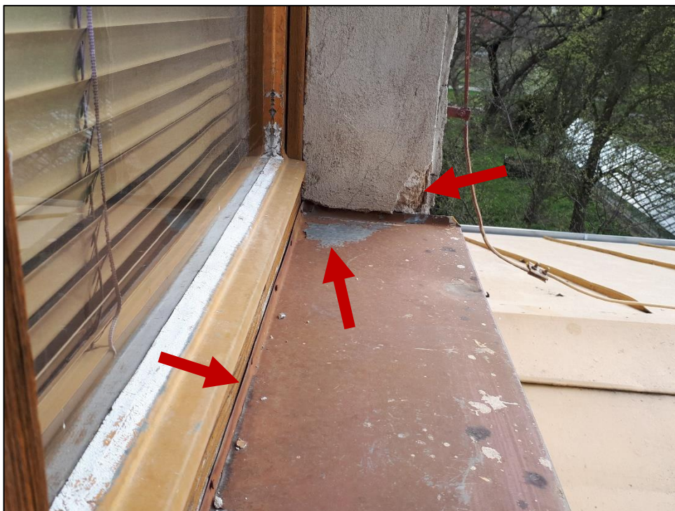
Foto č. 43 – Dtto Foto č. 40, netěsné napojení na okenní rám – riziko zatékání a další degradace oken. Rozsáhlé odlupování ochranného nátěru oplechování (hlavní budova).
