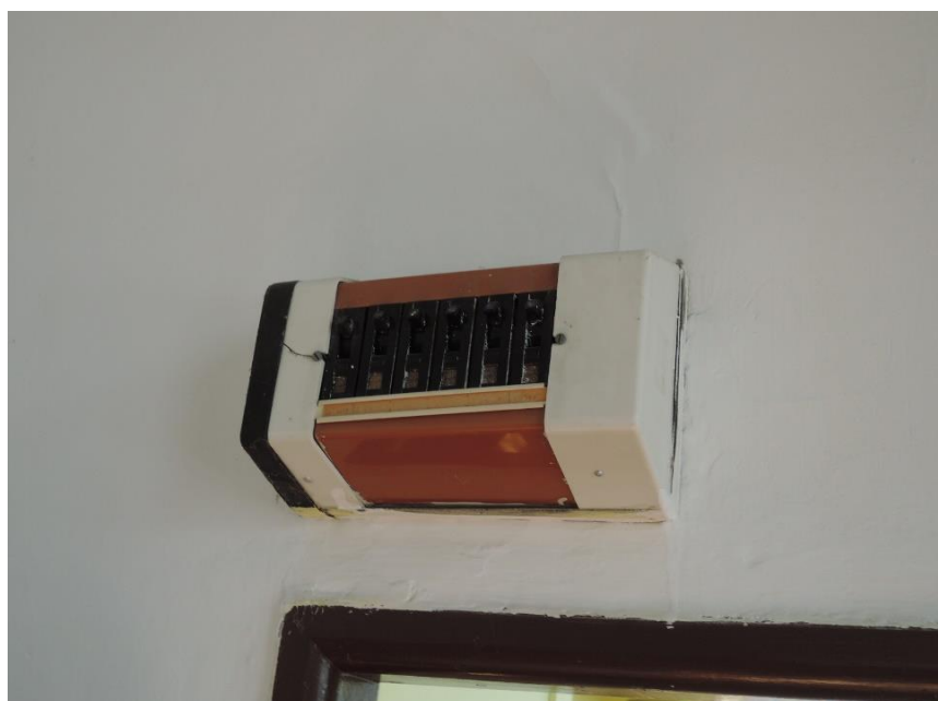
Foto č. 6 – podružný plastový rozvaděč pro třídu
