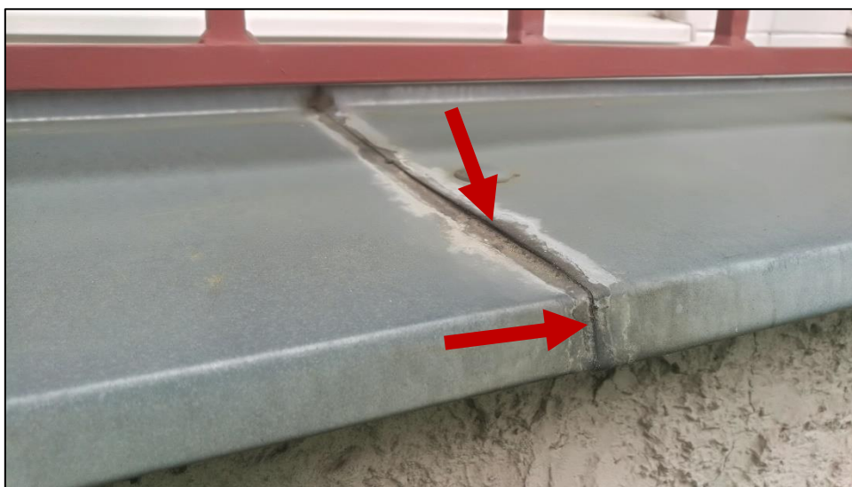
Foto č. 46 – Netěsnosti v napojení průběžných parapetů – vysoké riziko zatékání.
