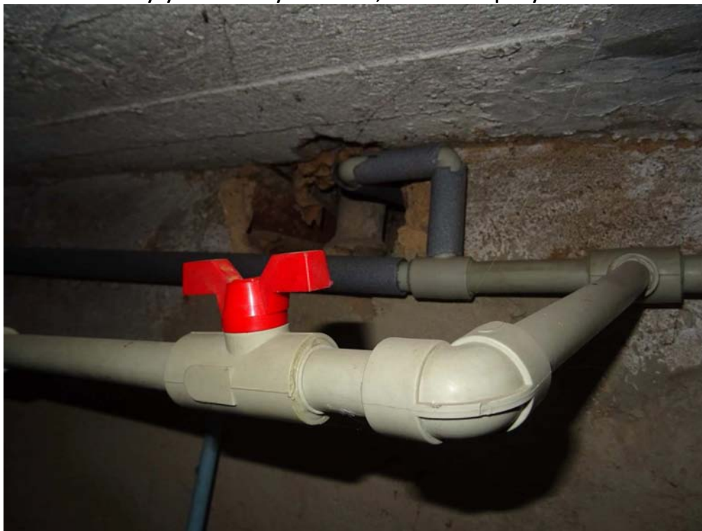
Obrázek 42 – Rozvody vody plastové bez izolací
