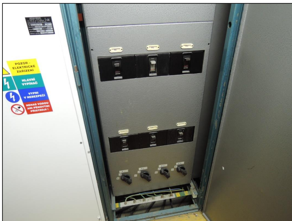
Foto č.4 – Rozvaděč v rozvodně
