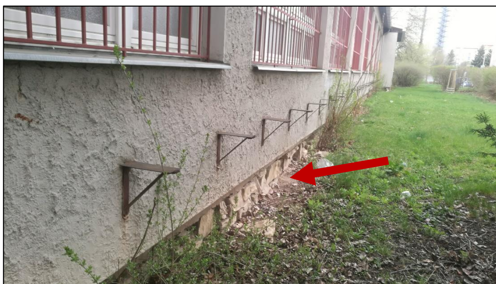
Foto č. 12 – Rozpad kamenné přizdívky soklu, absence okapového chodníku.
