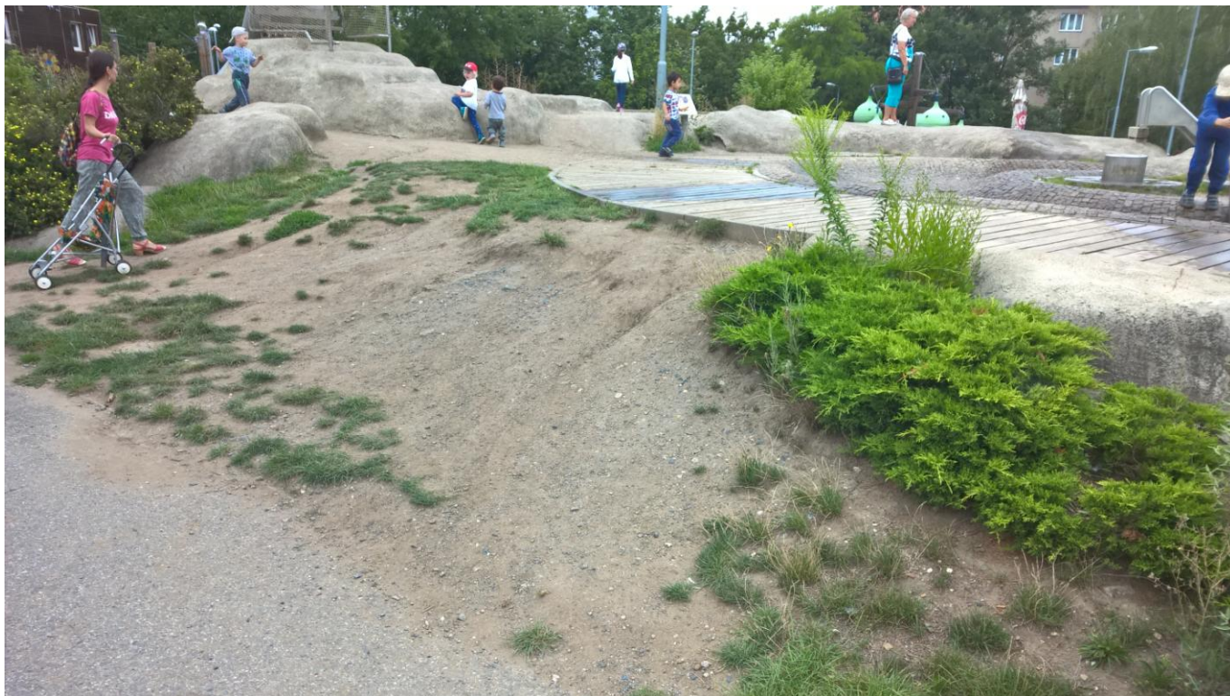
Obrázek 4- stávající konstrukce svahů vodního světa generuje zvýšenou potřebu údržby
