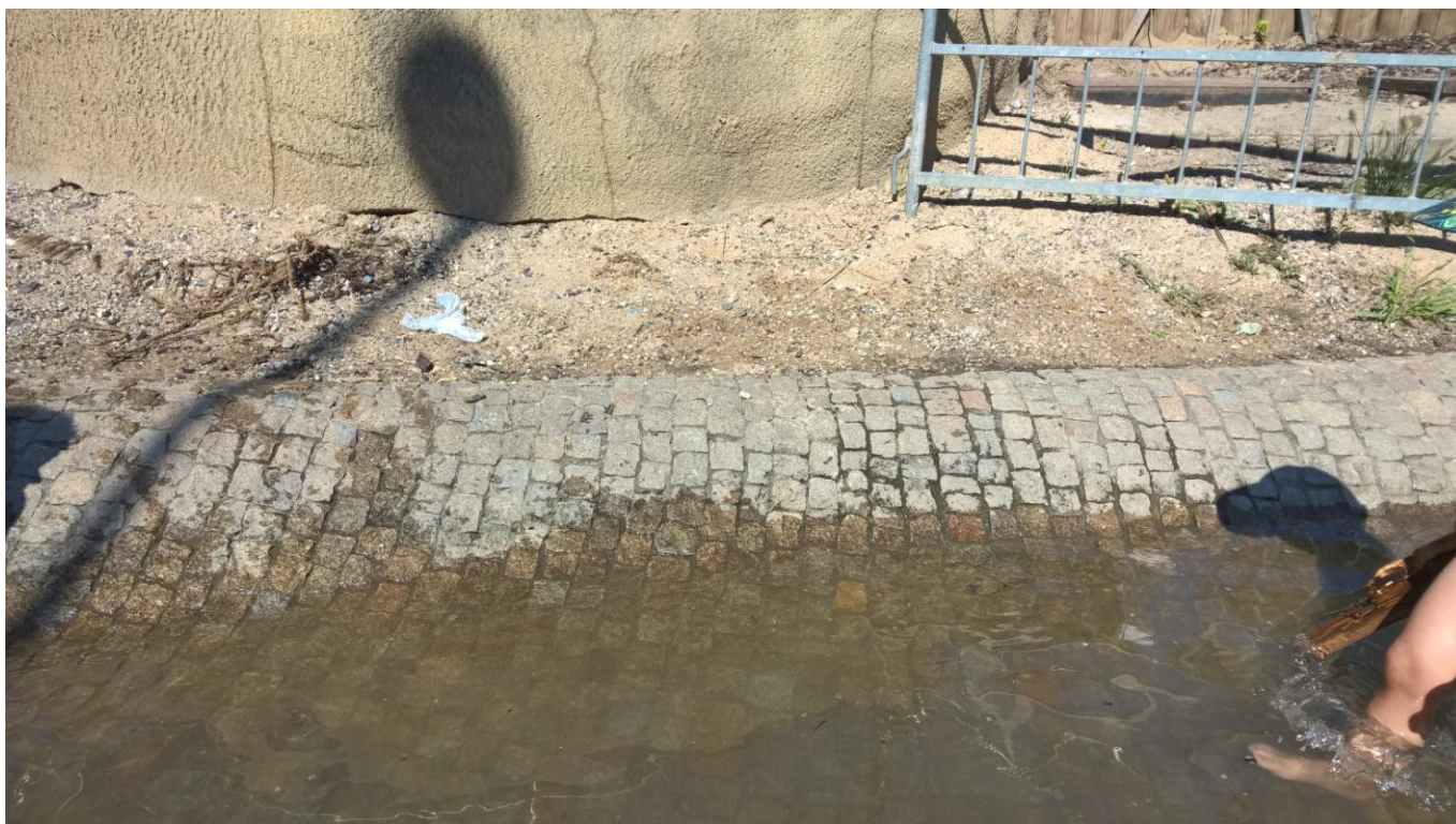
Obrázek 5 - Erodované svahy zanášejí vodní koryto a v důsledku pak filtry a čerpadla atrakcí
