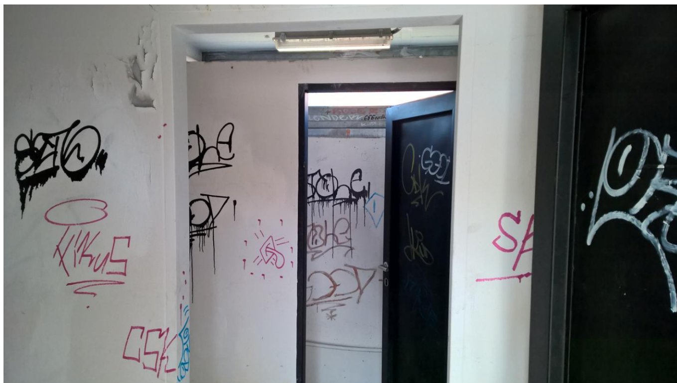
Obrázek 9 - objekt toalet u skateparku je v horším stavu než zbytek areálu
