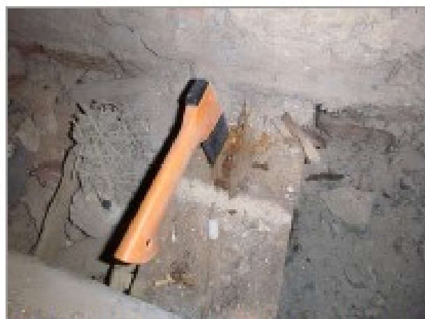
foto 28: Vážné poškození trémové zhlaví stropu nad 2.NP
