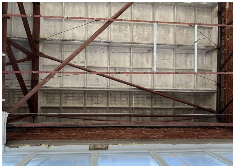
Krajní panel je nejvíce zasažen poruchami – množství otvorů v panelu, propsaná hlavní výztuž panelu.
