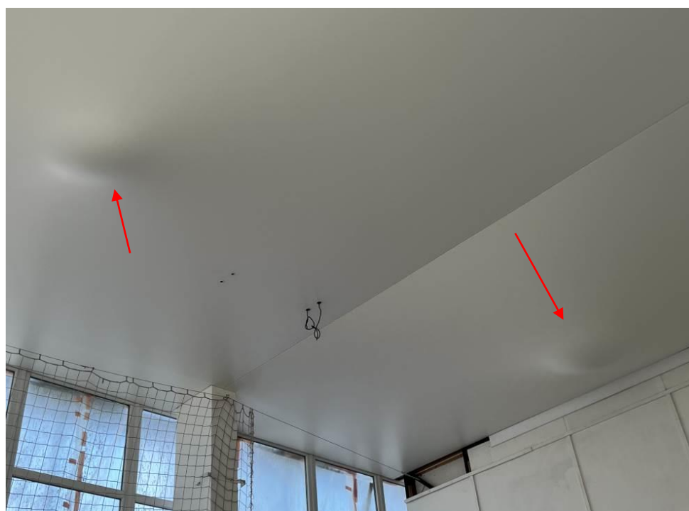
Obr. 5 Pohled na podhled s viditelnými bublinami s vodou
