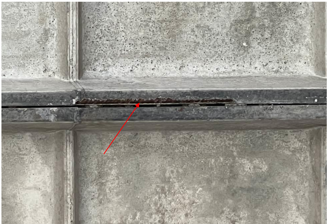
Odpadnutá krycí vrstva betonu, zkorodovaná hlavní výztuž.
