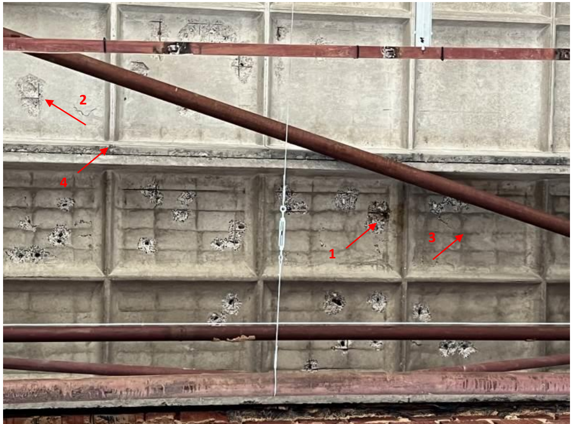
1-Viditelné poškození krycí vrstvy betonu v místě otvorů, 2-odpadávající krycí vrstva betonu, 3-propsaná výztuž panelu, 4-poškození žeber panelu.
