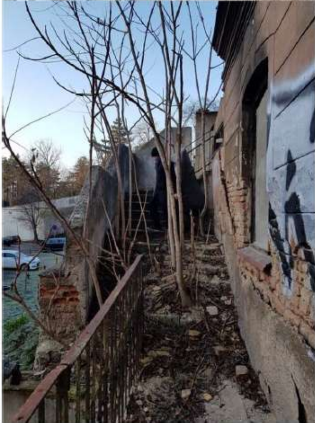
Schodiště a zarostlá pavlač 01/2020
