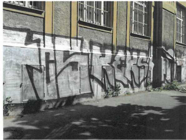
VANDALISMUS (JIŽNÍ – HLAVNÍ FASÁDA OBJEKTU)
