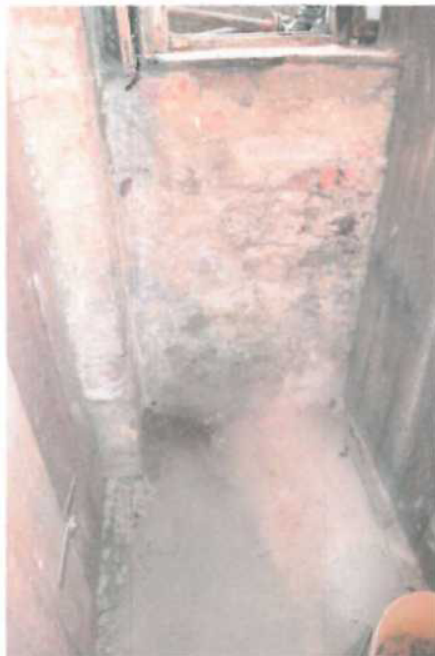
Poškozená vnitřní obvodová zeď objektu č.p. 829
