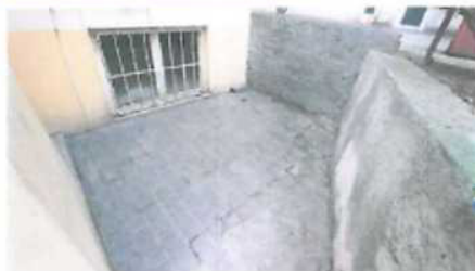
Porušená dlažba a opěrná zeď
