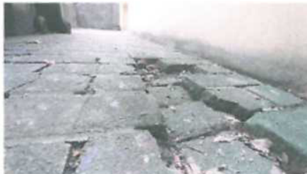
Propadlá dlažba u objektu č.p. 829
