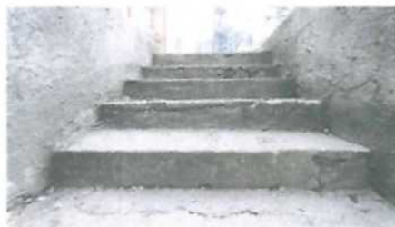
Klimatickými vlivy narušené schodišťové stupně
