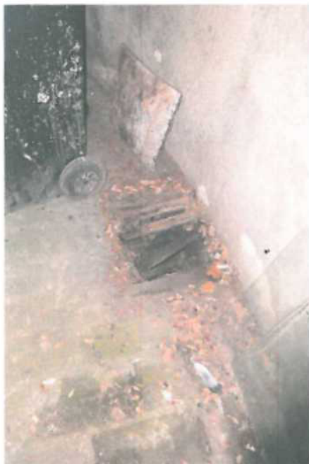
Chybějící poklop kanalizační vpusti a ucpaný odtok
