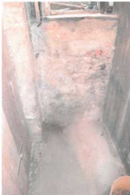
Poškozená vnitřní obvodová zeď objektu č.p. 829
