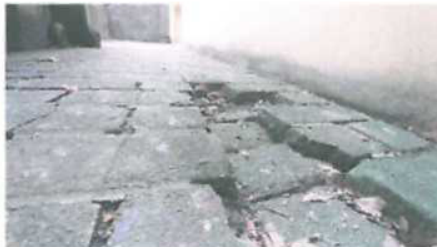
Propadá dlažba u objektu č.p. 829
