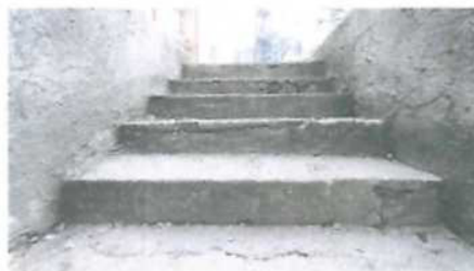
Klimatickými vlivy narušené schodišťové stupně
