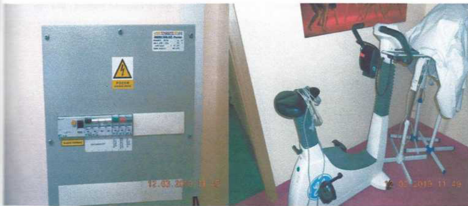
obr. č.44 - el. rozváděč k RTG
