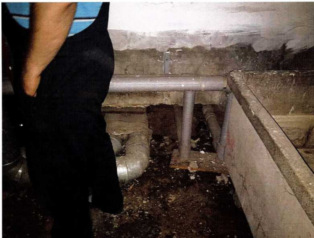
Obr. 5 - Rozvody v jednotce 699/20 – propojení do společného kanálu, Vršovická 699/74
