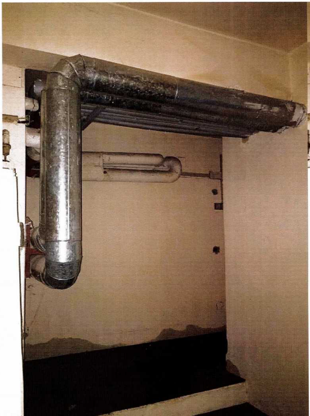
Obr. 3 - Vstup do jednotky 699/20 – společné rozvody v předsíni, Vršovická 699/74
