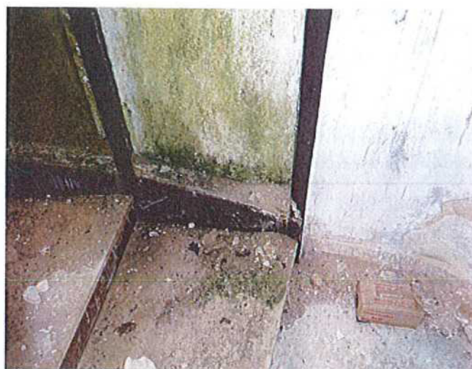
Řasy na vlhké zdi v místě zatékání
