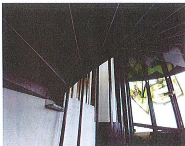
Otevřené ocelové schodiště bez protipožární ochrany
