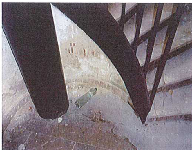
Degradace prosolené omítky
