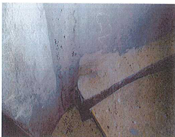
Degradace omítky, místo odběru vzorku S2
