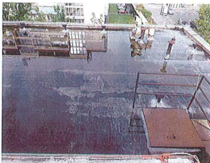
Ucpaný odtok, zaplavená plochá střecha
