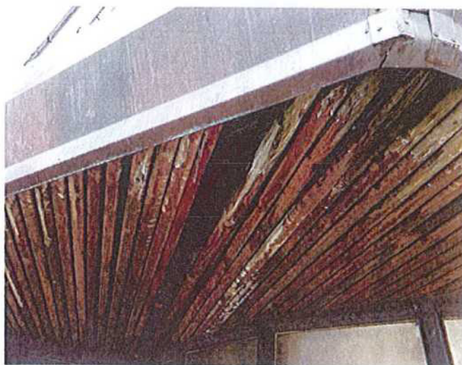
Dřevěný pohled vnější konzoly poškozený zatékáním
