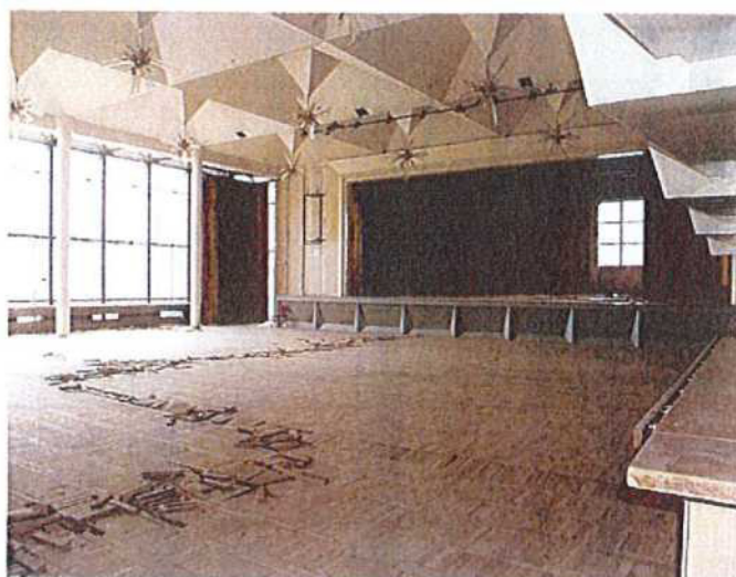
Poškozená podlaha sálu
