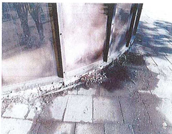
Přímé zatékání povrchové vody do objektu
