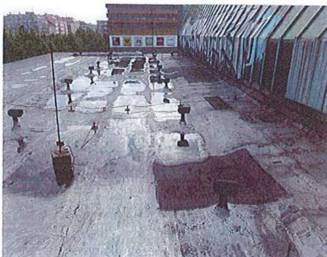
Nerovnosti ploché střechy a kaluže
