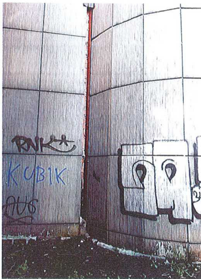
Železobetonové sendvičové panely, tepelný most
