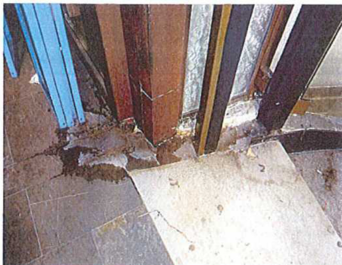
Místo S3 zatékání do objektu
