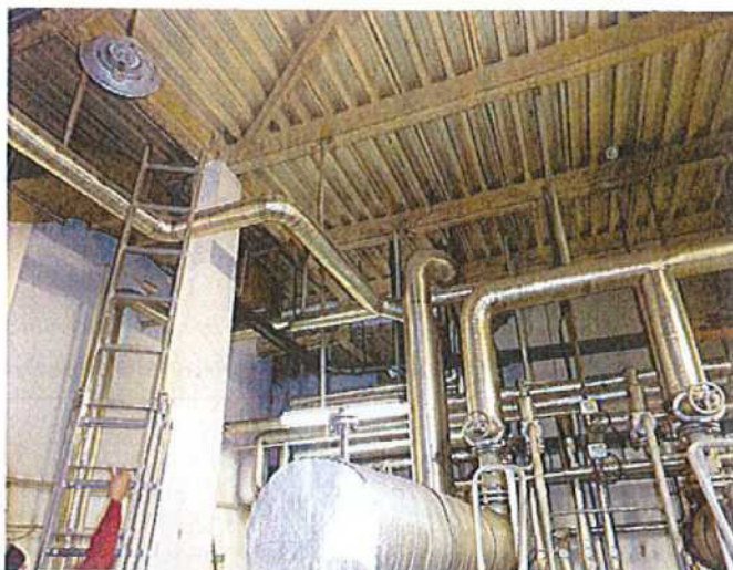
Strop nad kotelnou, nosníky s protipožárním nástřikem
