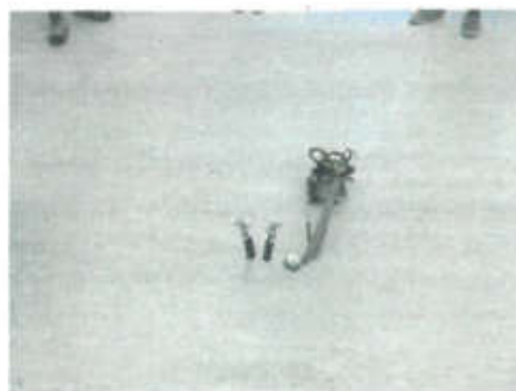
Přívod médií z podlahy
