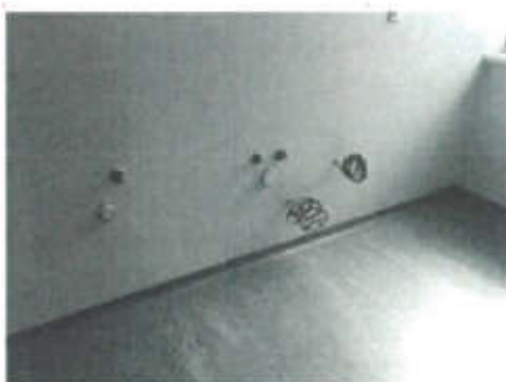
Přívod médií ze stěny
