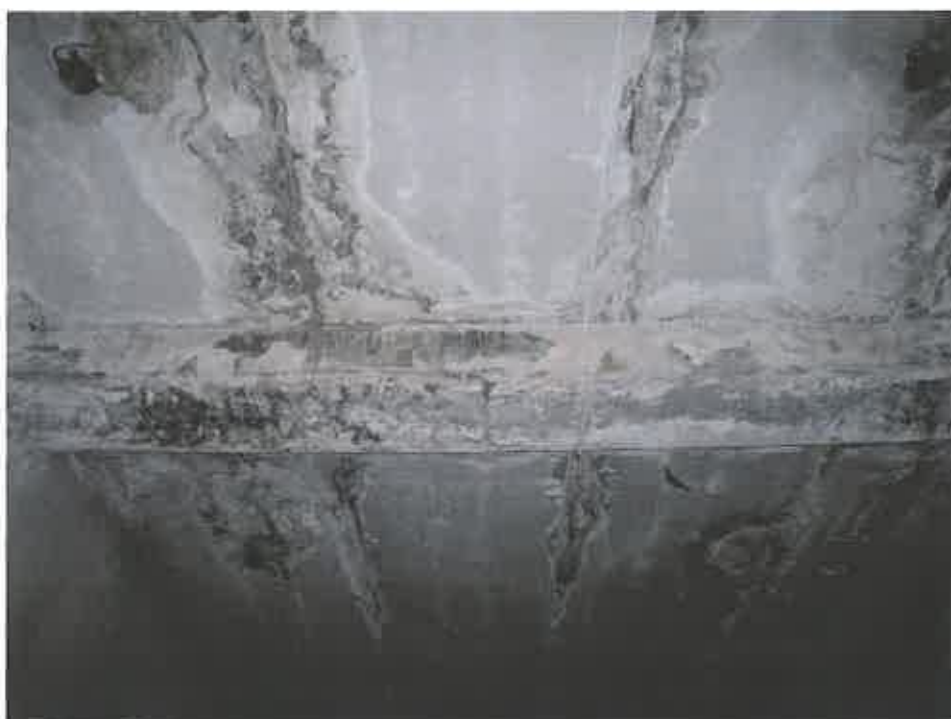
Obr. 28: Suterén u budovy A – průsaky stropem pod terasou
