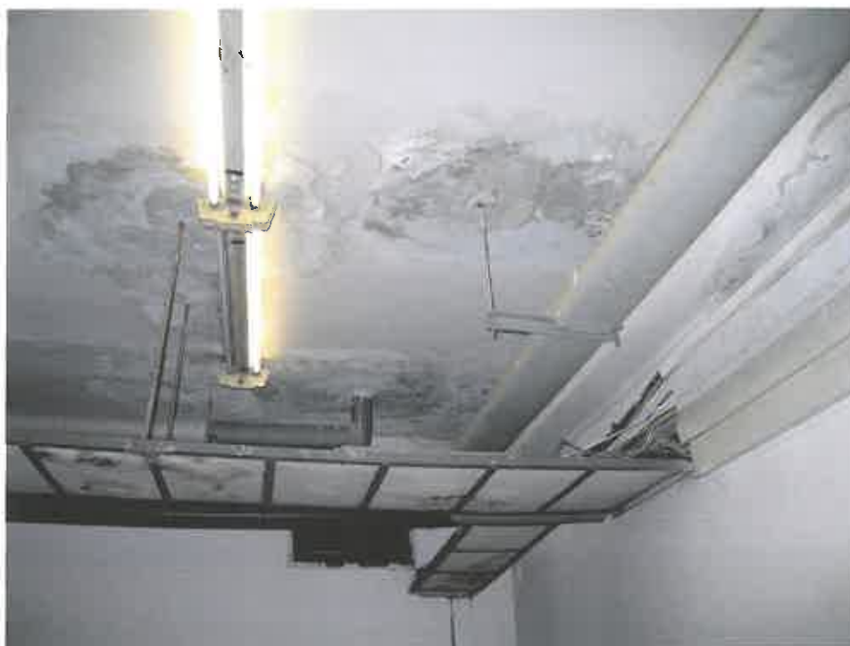
Obr. 15: Suterén u budovy B – průsaky stropu pod terasou
