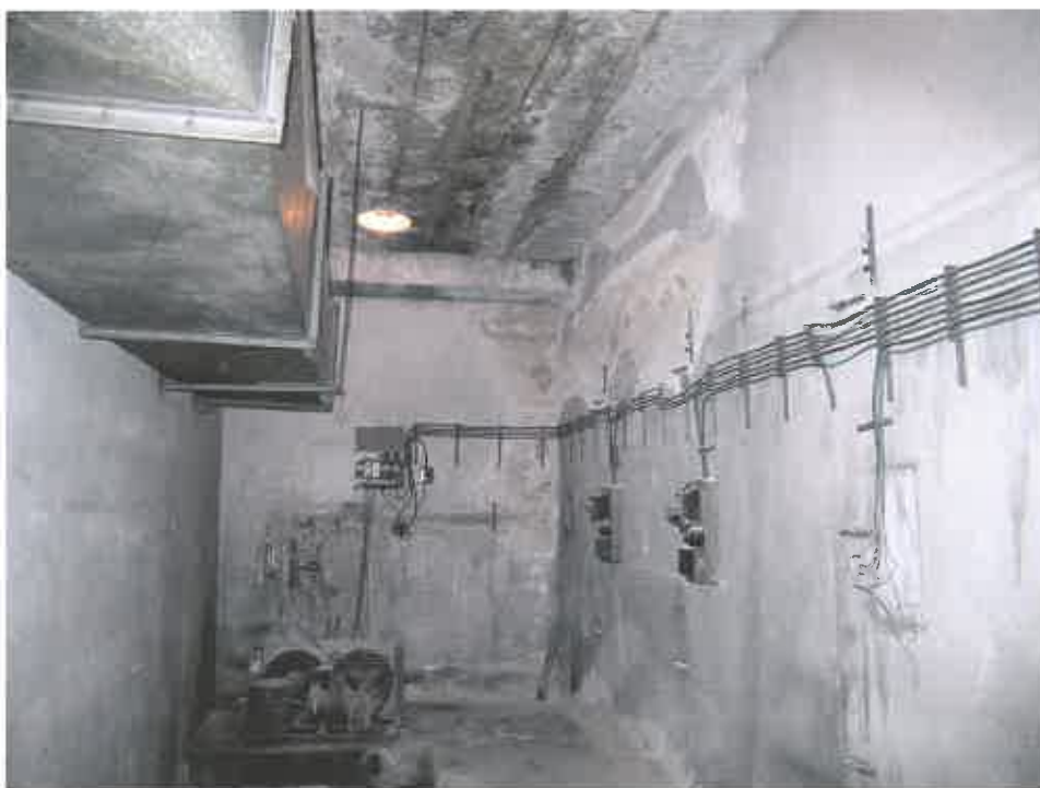
Obr. 10: Suterén u budovy C – průsaky stropu pod terasou
