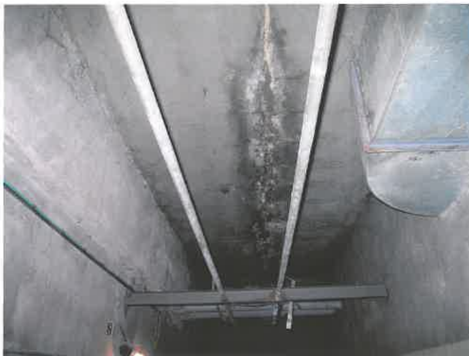
Obr. 11: Suterén u budovy C – průsak stropu pod terasou
