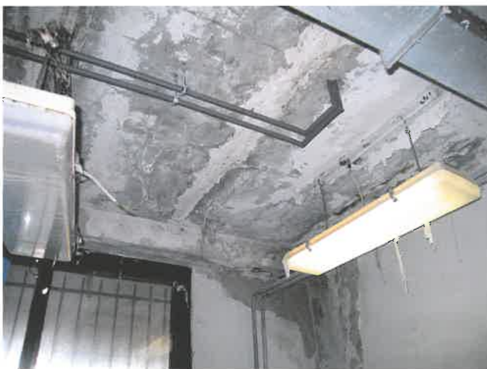
Obr. 14: Suterén u budovy C – průsaky stropu pod terasou
