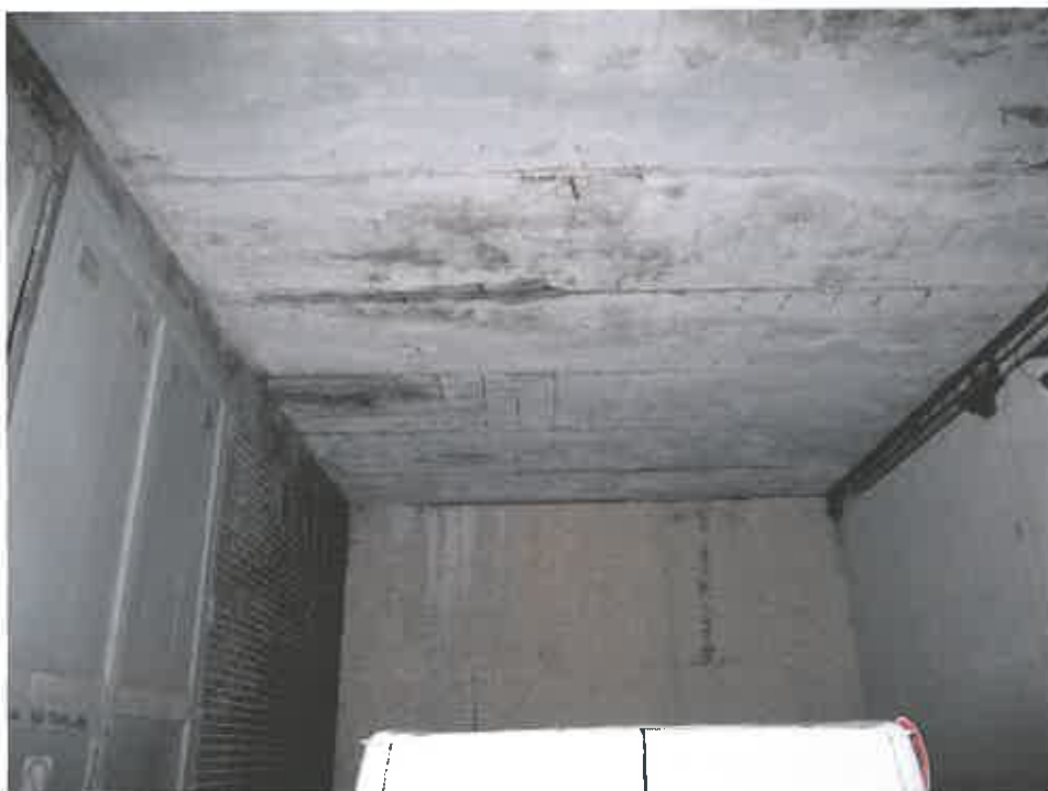
Obr. 28: Suterén u budovy A – průsaky stropu pod terasou
