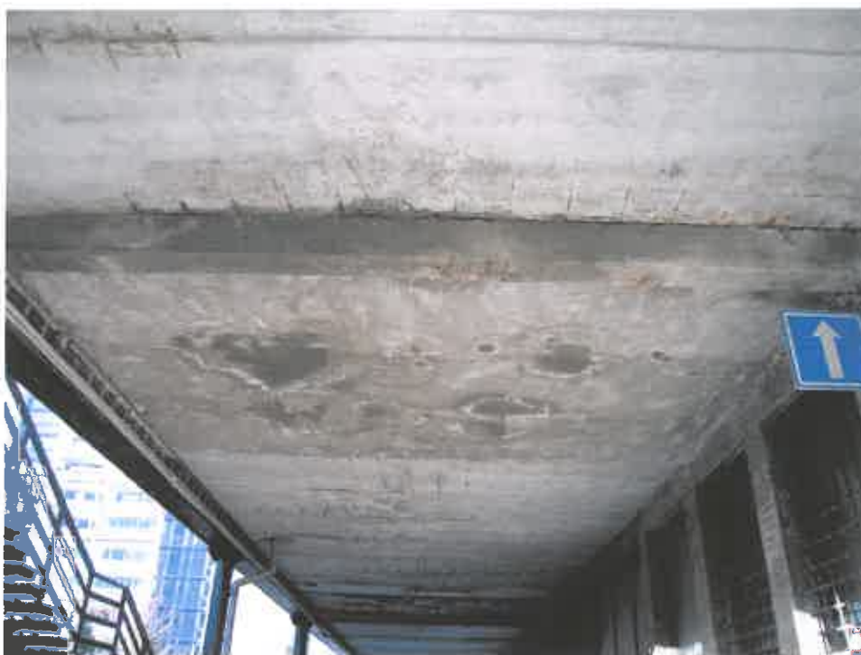
Obr. 5: Průsaky v panelech nad komunikací po opravě
