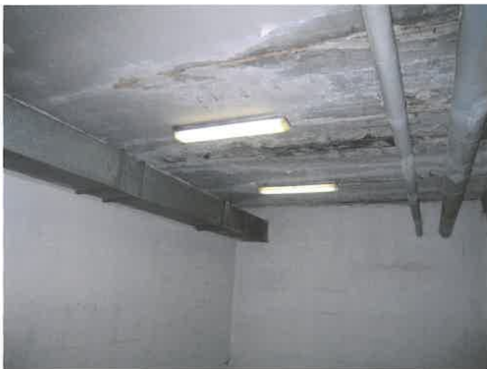
Obr. 12: Suterén u budovy C – průsak stropu pod terasou
