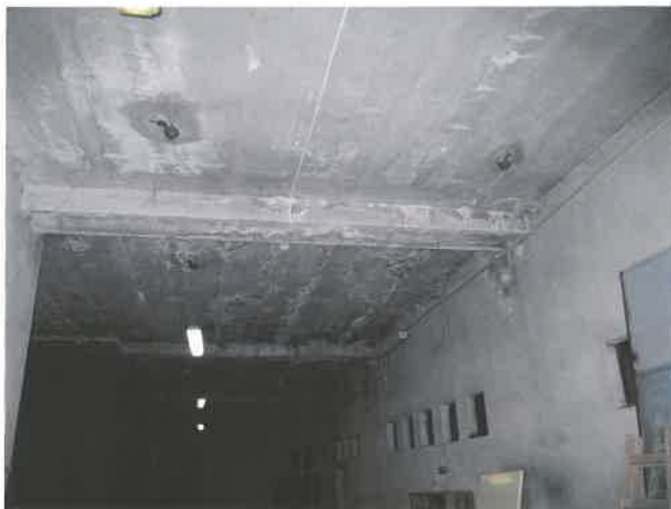
Obr. 27: Suterén u budovy A – průsaky stropem pod terasou
