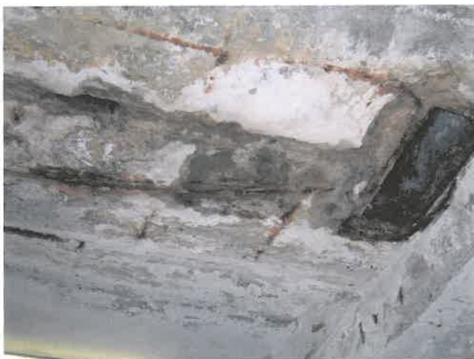
Obr. 8: Suterén u budovy C – průsak u stropní ventilace pod terasou
