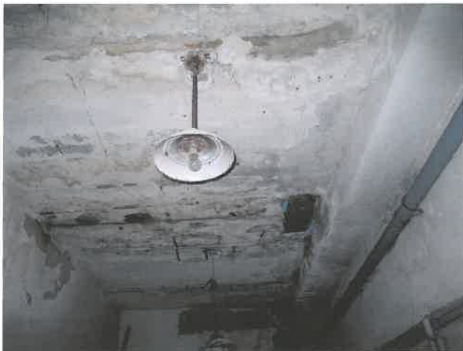
Obr. 23: Suterén u budovy B – průsaky stropem pod terasou
