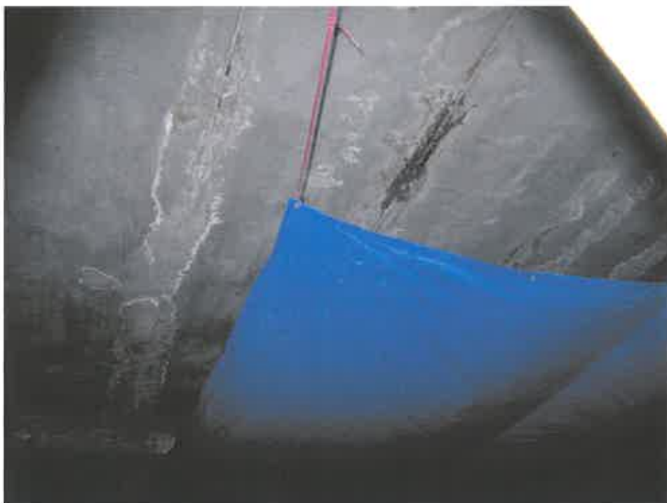
Obr. 26: Suterén pod budovou B – průsaky spárami mezi panely
