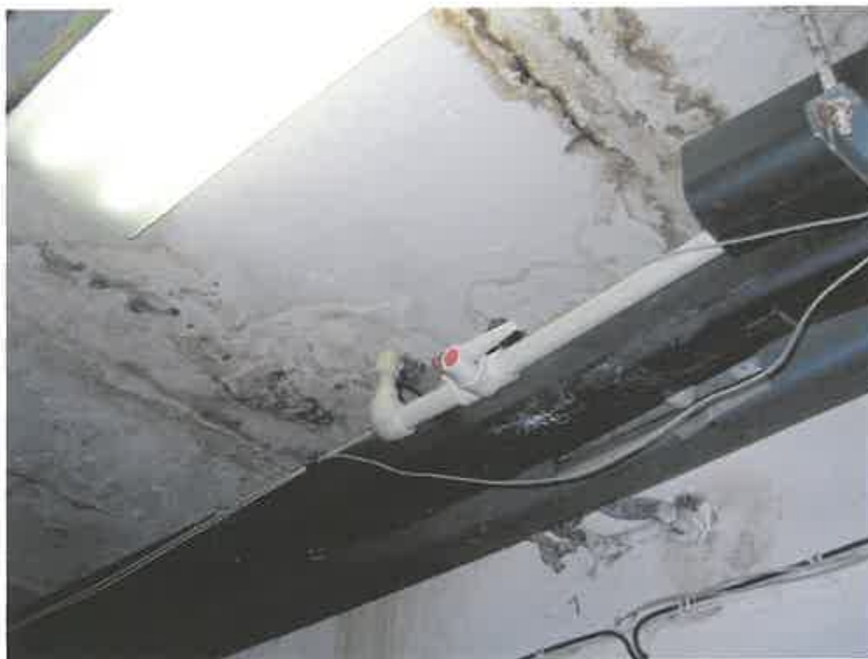
Obr. 17: Suterén pod budovou B – průsaky spárami mezi panely
