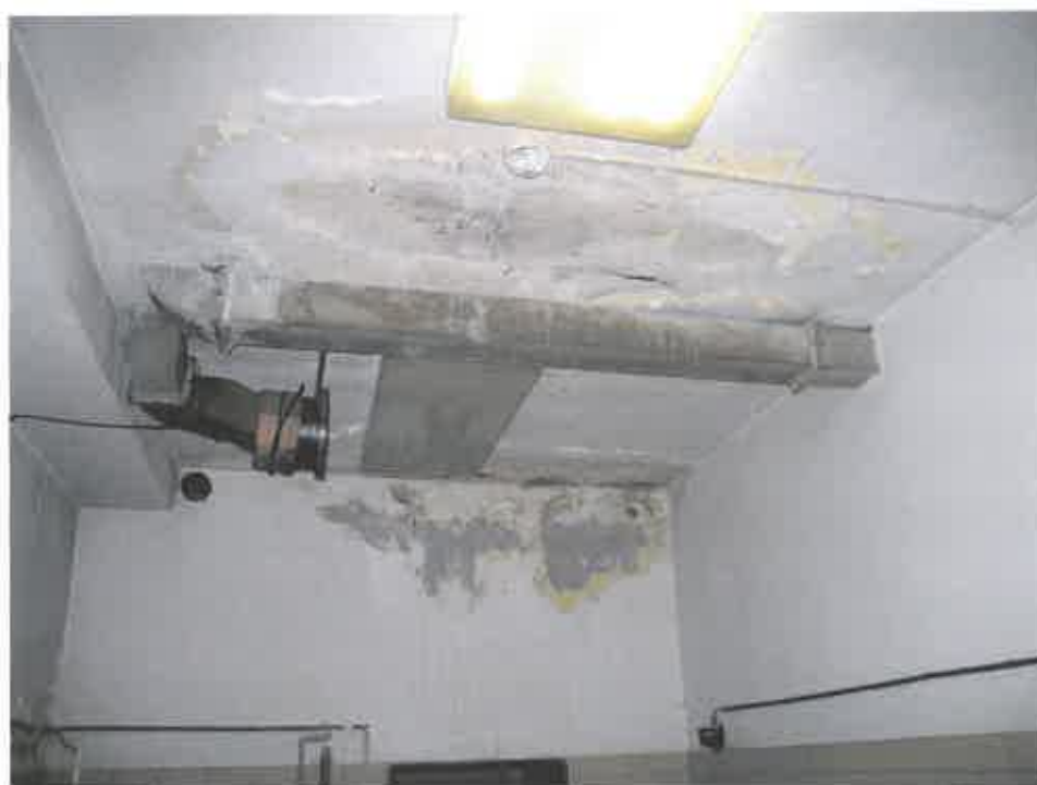
Obr. 18: Suterén u budovy B – průsaky stropu pod terasou
