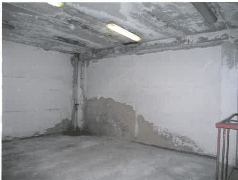
Obr. 9: Suterén u budovy C – průsaky stropem pod terasou
