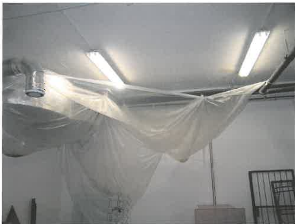
Obr. 25: Suterén u budovy A – průsaky stropu pod terasou
