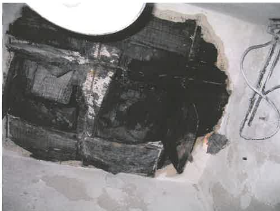
Obr. 24: Suterén u budovy B – zřícení stropu v chlazeném skladu
