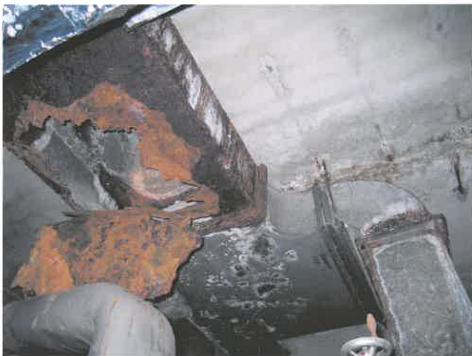
Obr. 22: Suterén u budovy B – poškození TZB vlivem zatékání
