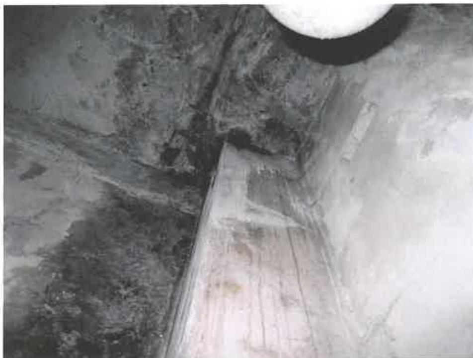
Obr. 19: Suterén u budovy B – průsaky stropu pod terasou
