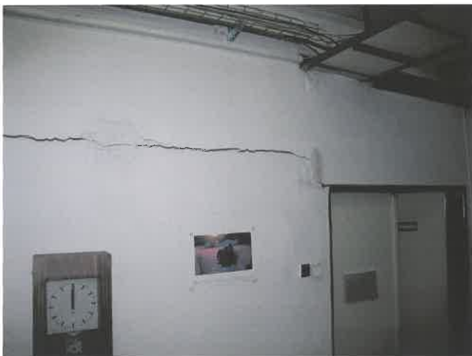
Obr. 16: Suterén u budovy B – statická porucha svislé stěny
