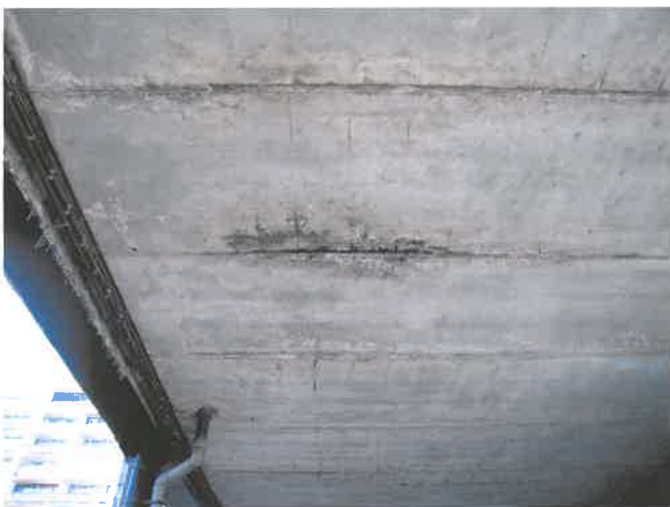
Obr. 6: Průsaky spárou mezi panely nad komunikací
