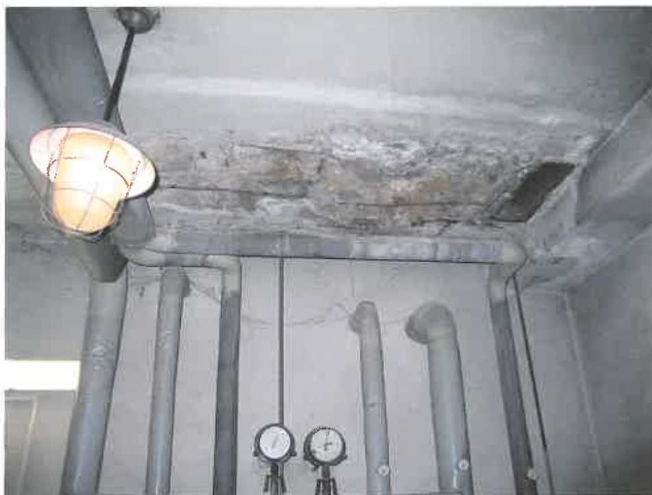
Obr. 13: Suterén u budovy C – průsak u stropní ventilace pod terasou
