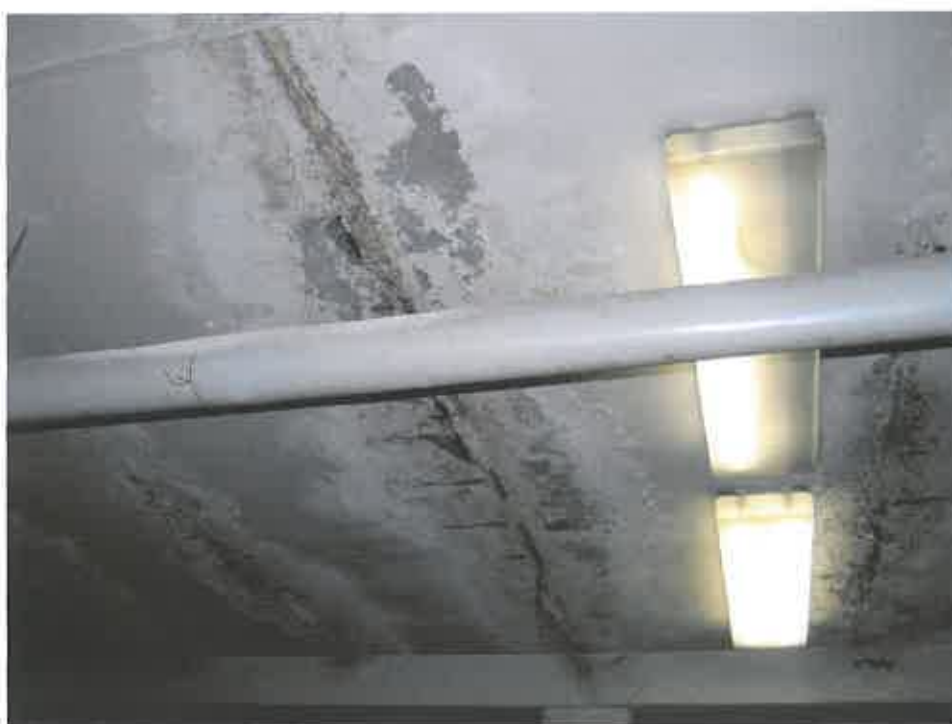
Obr. 20: Suterén u budovy B – průsaky stropu pod terasou
