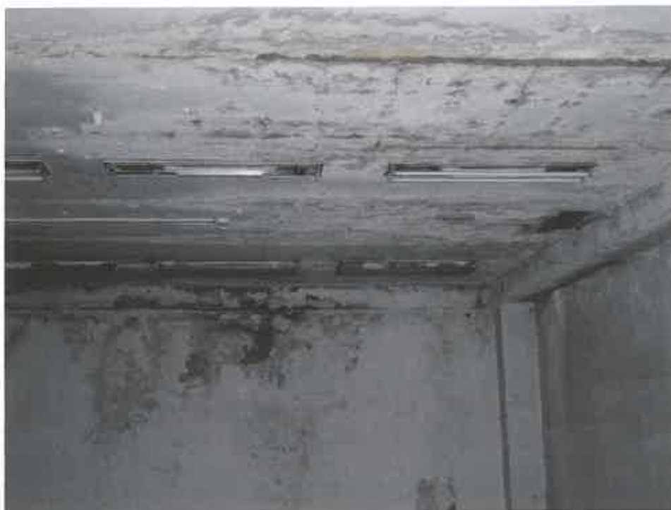
Obr. 7: Suterén u budovy C – průsaky stropu pod terasou
