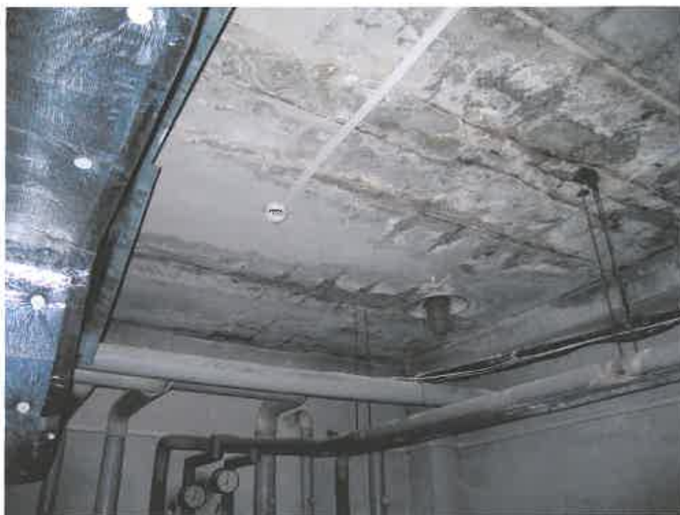
Obr. 21: Suterén u budovy B – průsaky stropu pod terasou
