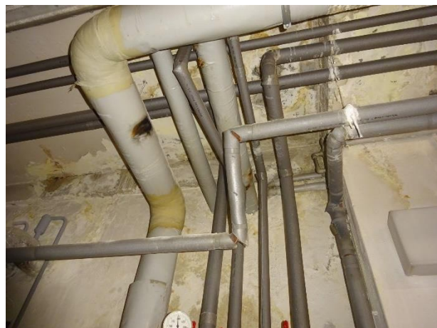
Rozvody ve výměňíkové stanici
