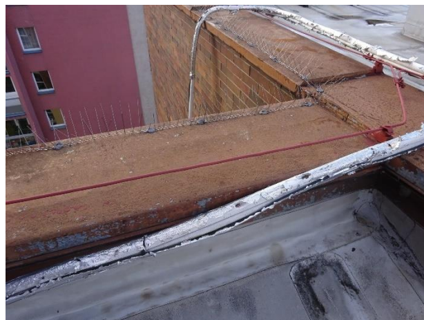
Degradace tepelné izolace potrubí
