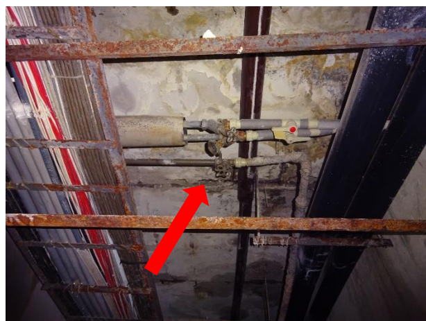
Ocelové a plastové rozvody vodovodu
