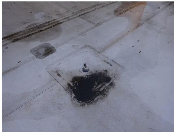
Střešní vpust' bez ochranného koše – doporučujeme doplnit
