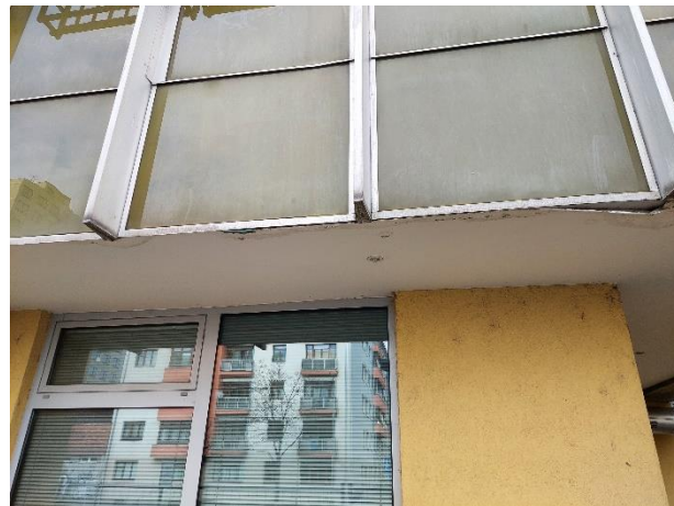
Degradovaný SDK pohled
