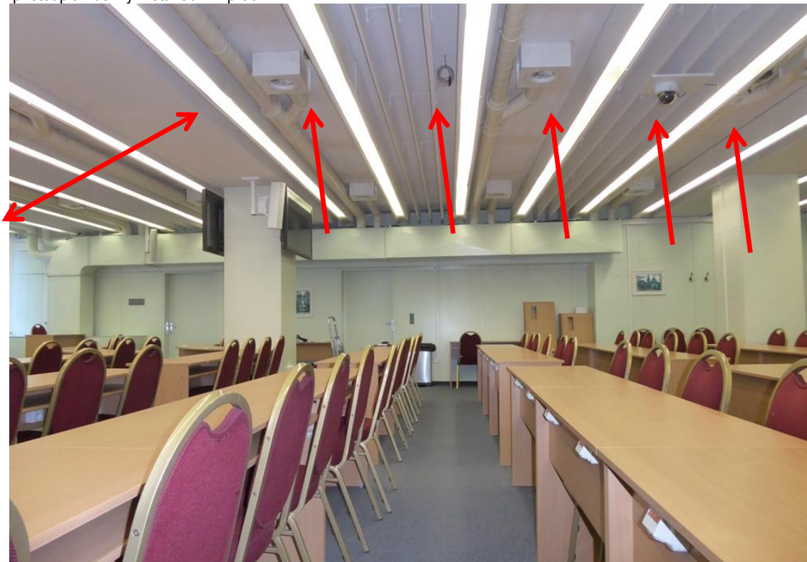
Foto č. 1 – Budova B, 1. patro, velká zasedací síň č.m. B131. PŮVODNÍ STAV V ROCE 2018. Kabelové trasy se zářivkami kryté sklem, které jsou uvnitř vyloženy měkkými azbestovými deskami.
