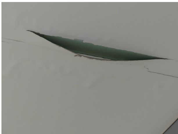
Odpadávající tmel SDK podhledu
