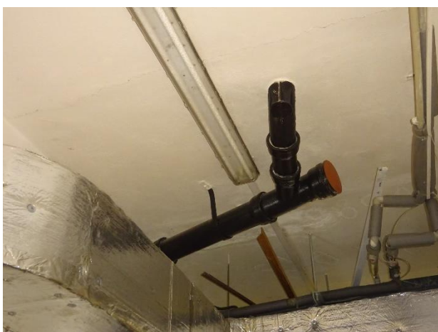
Litinové potrubí kanalizace
