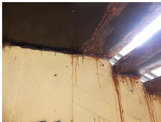
Degradované ocelové části schodiště
