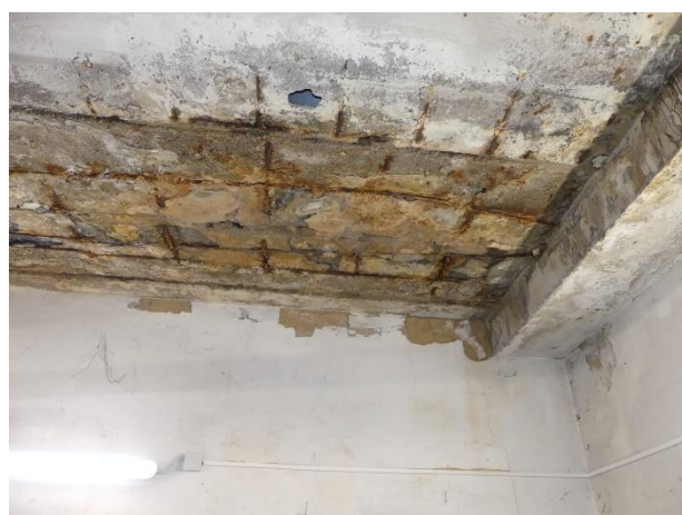
Viditelná degradace stropního panelu
