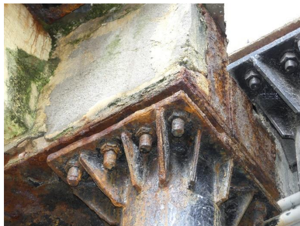
Koroze na ocelových sloupech
