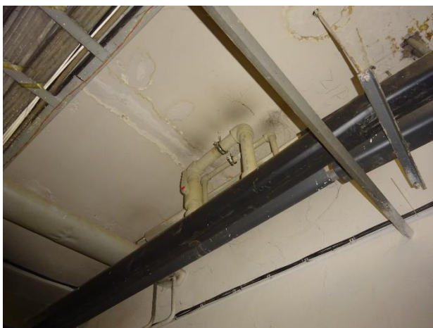
Plastové potrubí vodovodu
