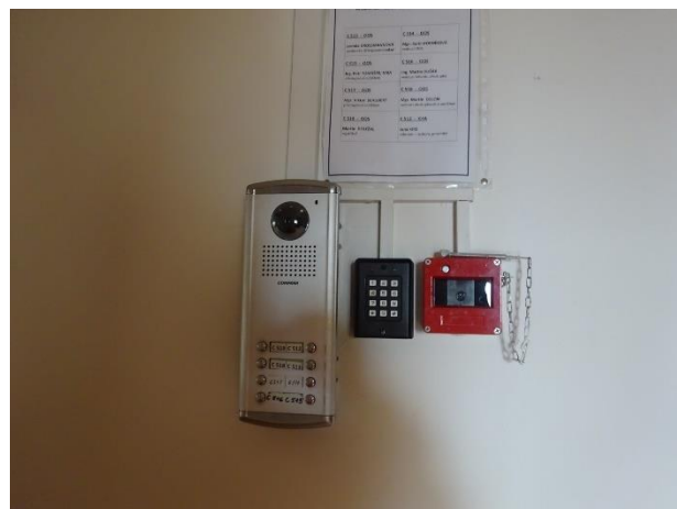
Zvonkové tablo a klávesnice EZS/ACS (přístupový systém)
