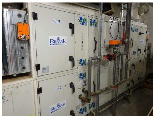
VZT jednotka Remak
