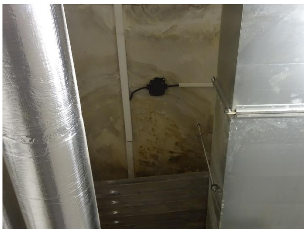
Kabely a krabice v místě prosakující vody do objektu
