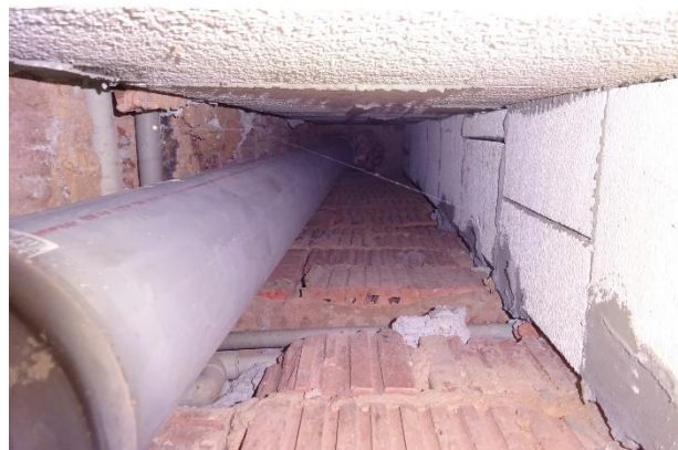
Instalační šachta – plastové HT potrubí kanalizace z roku 1998 (1.NP)
