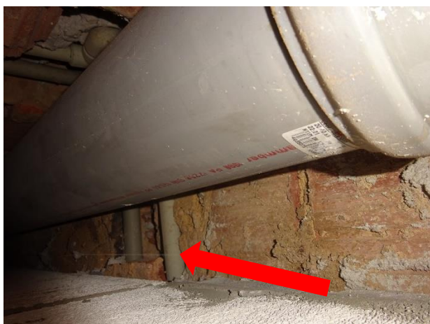
Plastové potrubí v instalační šachtě bez tepelné izolace s přímým kontaktem se zdívm/maltou/omítkou
