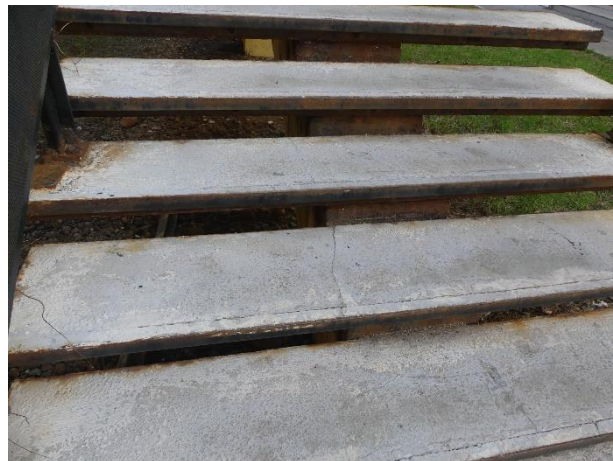
Popraskané nášlapné vrstvy
