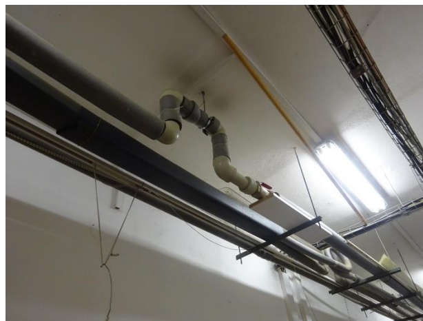
Plastové potrubí vodovodu
