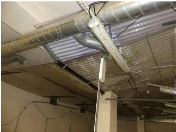
Odvod protékající vody do svodu
