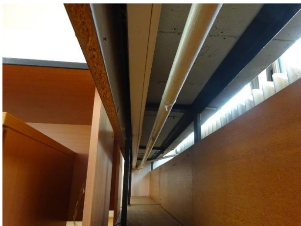
Vedení potrubí pod parapetem okna
