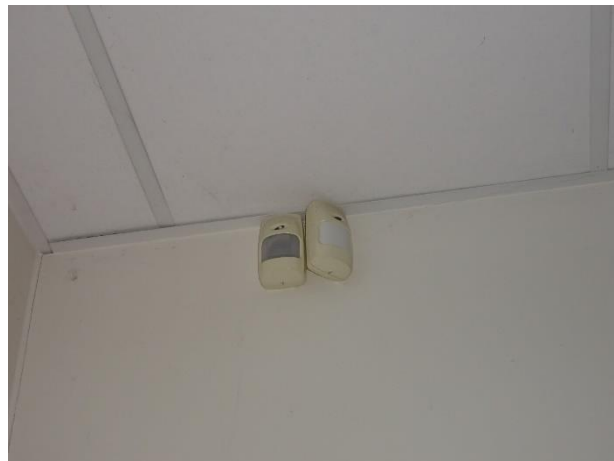
Čidlo elektronické zabezpečovací signalizace (EZS)
