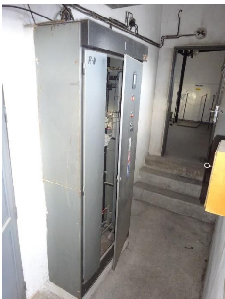
Rozvaděč u baterkárny
