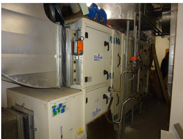
VZT jednotka Remak
