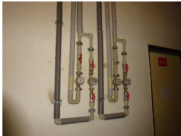
Plastové potrubí vodovodu
