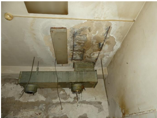
Viditelná degradace stropního panelu
