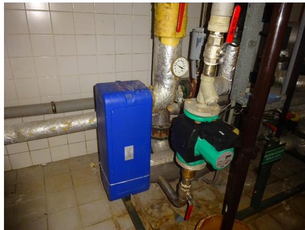
Tepelný výměník ohřevu teplé vody
