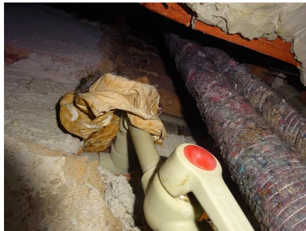
Rozvody vodovodu – chybějící tepelná izolace
