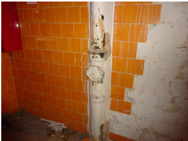
Litiné potrubí kanalizace
