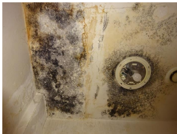
Svítlidlo bez krytu a v místě prosakující vody do objektu
