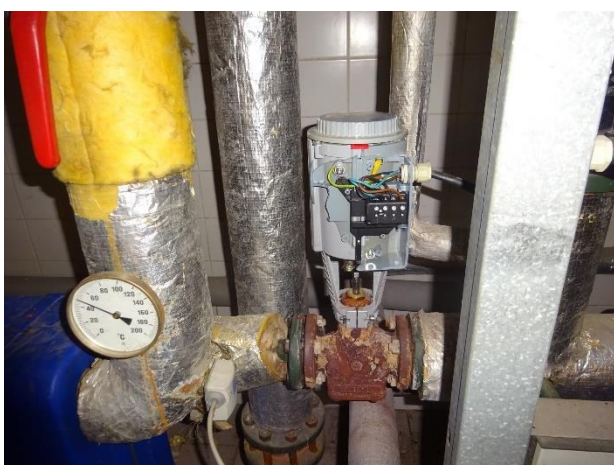
Koroze armatury a poškozený kryt napojení servopohonu na el. energie
