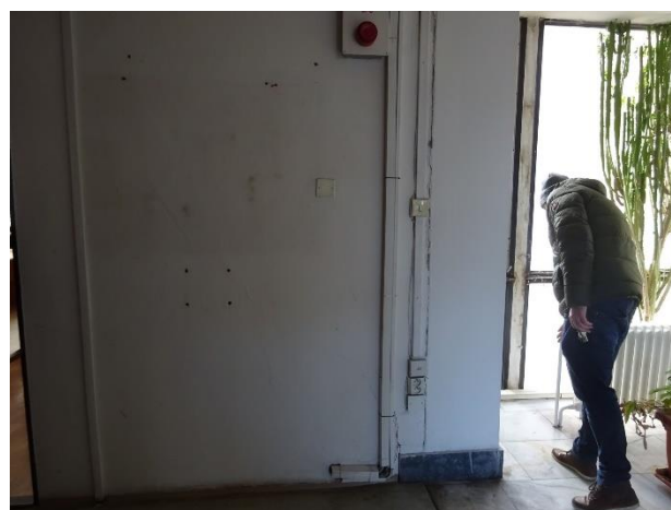
Vedení elektroinstalace v lištách
