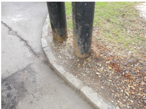
Koroze na ocelových sloupech
