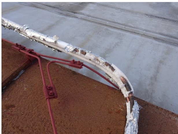
Degradace tepelné izolace potrubí
