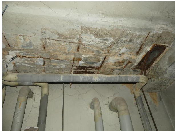
Viditelná degradace stropního panelu
