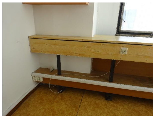
Datové a silnoproudé zásuvky
