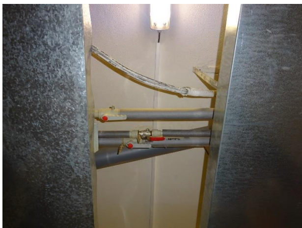
Plastové potrubí vodovodu
