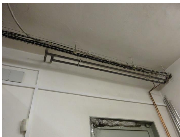
Novější trasa elektroinstalace v drátěném žlabu
