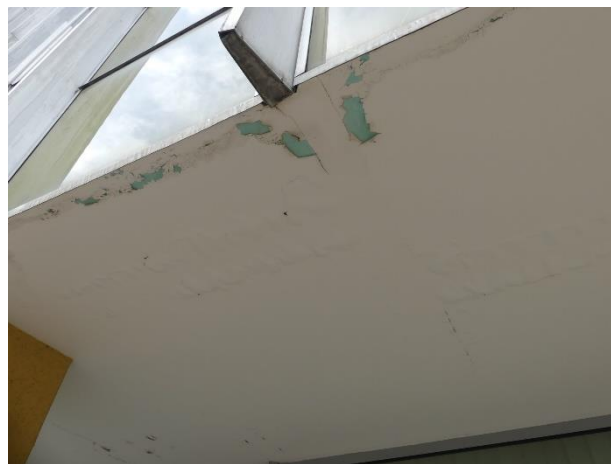
Odlupující se SDK povrch
