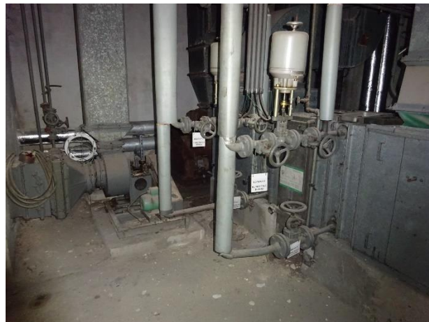
Zastaralá VZT jednotka
