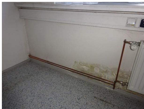
Novější měděné potrubí
