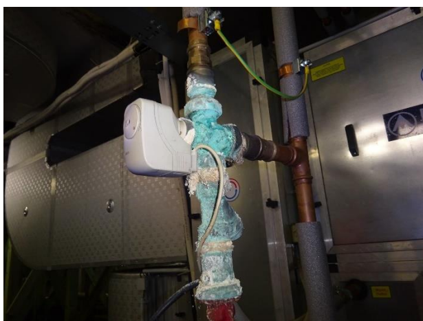
Viditelné úniky topné vody
