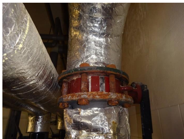
Mírná koroze uzavírací armatury
