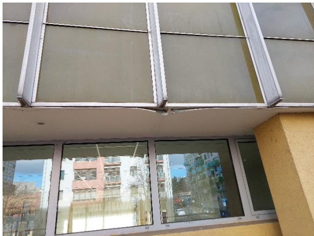
Degradovaný SDK pohled
