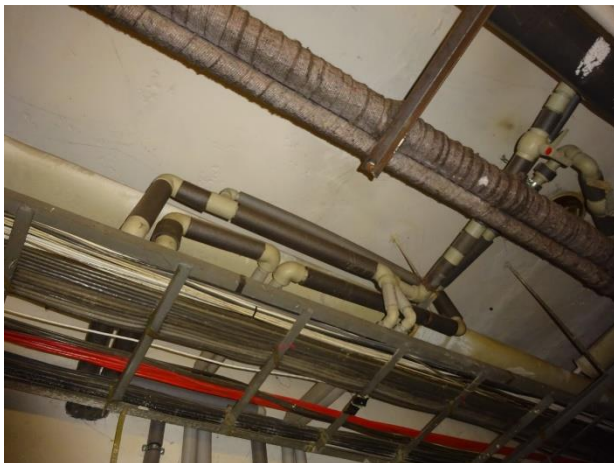
Plastové potrubí vodovodu
