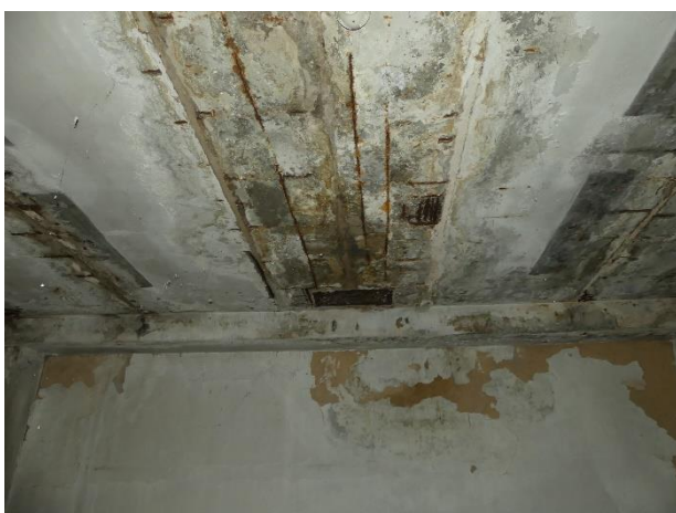
Viditelná degradace stropního panelu
