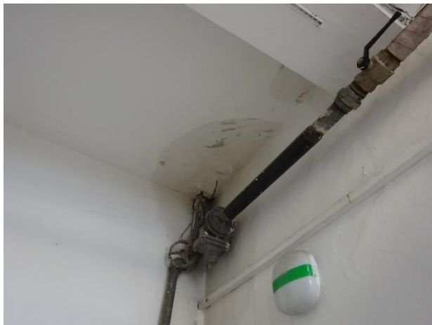
Ocelové potrubí vodovodu v suterénu
