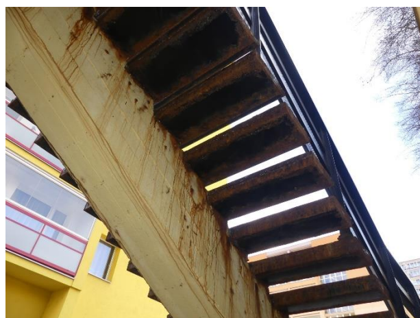
Degradované ocelové části schodiště
