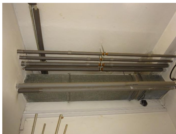
Novější měděné potrubí
