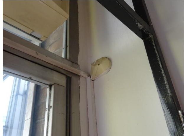
Vedení kabelů EZS
