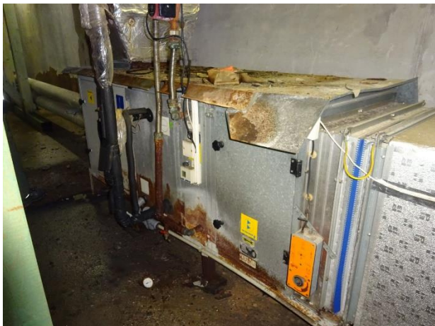
VZT jednotka napadena korozí, provizorně překryta plechem jako ochrana před zatékající vodou do suterénu
