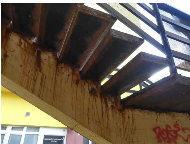
Degradované ocelové části schodiště
