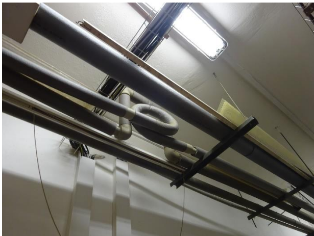
Plastové potrubí vodovodu
