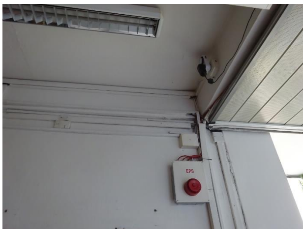
Vedení elektroinstalace v lištách
