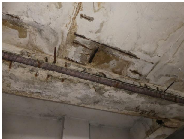
Viditelná degradace stropního panelu
