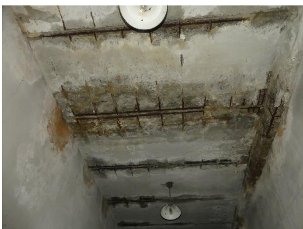
Viditelná degradace stropního panelu
