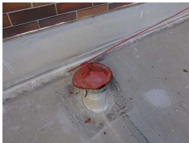
Silně zkorodovaná hlavička odvětrání kanalizace
