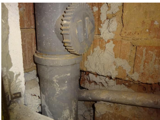
Instalační šachta – plastové HT potrubí kanalizace z roku 1998 (1.NP)
