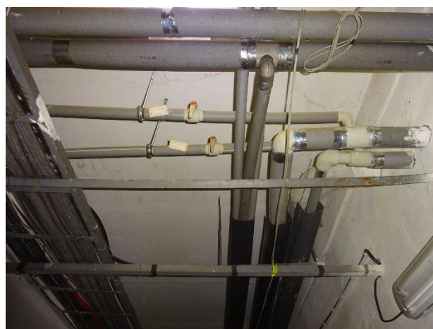
Plastové potrubí vodovodu
