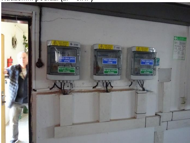
Novější elektroinstalace ve strojovně výtahu
