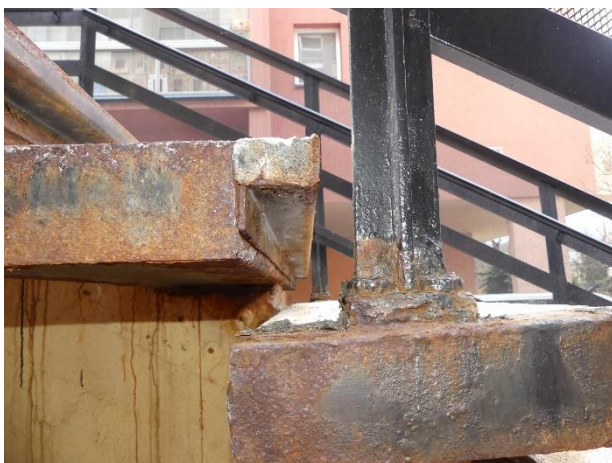
Degradované ocelové části schodiště
