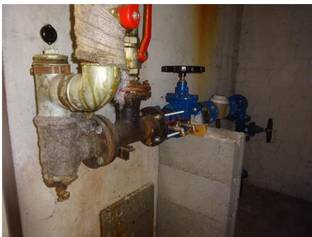
Přípojka vody s vodoměrnou sestavou
