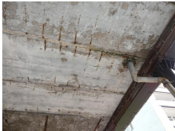
Viditelná korozí výztuže
