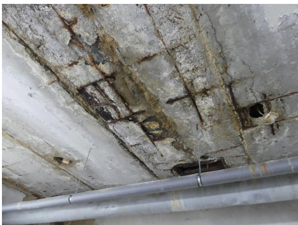
Viditelná degradace stropního panelu
