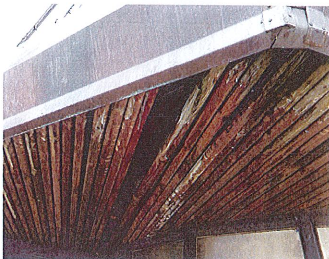
Dřevěný pohled vnější konzoly poškozený zatékáním
