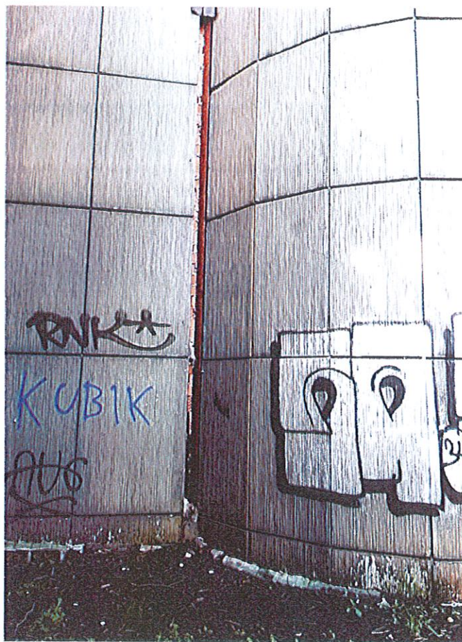
Železobetonové sendvičové panely, tepelný most
