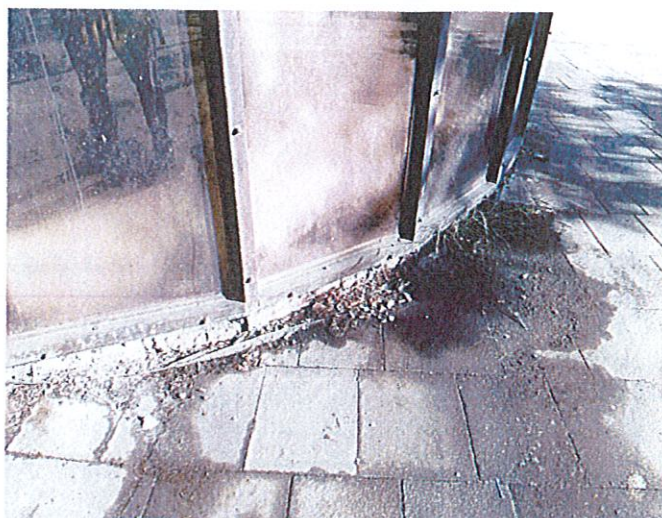
Přímé zatékání povrchové vody do objektu
