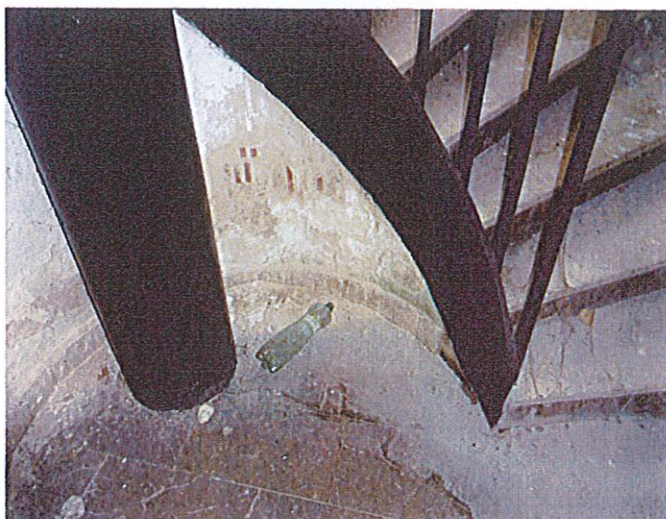
Degradace prosolené omítky
