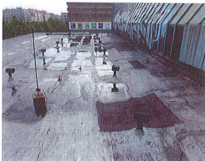
Nerovnosti ploché střechy a kaluže
