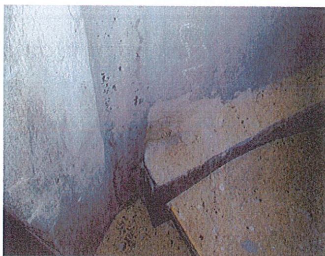
Degradace omítky, místo odběru vzorku S2
