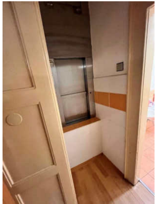
Výtah na jídlo
