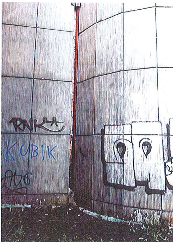
Železobetonové sendvičové panely, tepelný most
