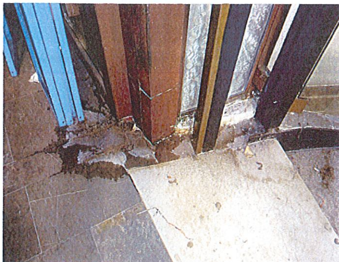
Místo S3 zatékání do objektu
