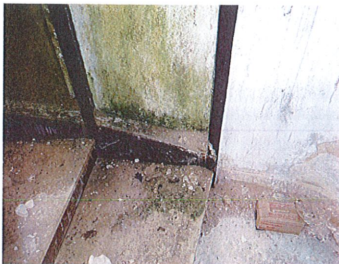
Řasy na vlhké zdi v místě zatékání
