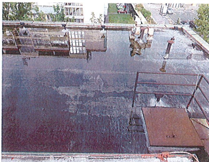
Ucpaný odtok, zaplavená plochá střecha
