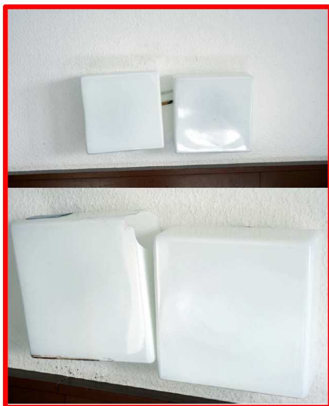
Světlo v pokoji propojené volným kabelem,
