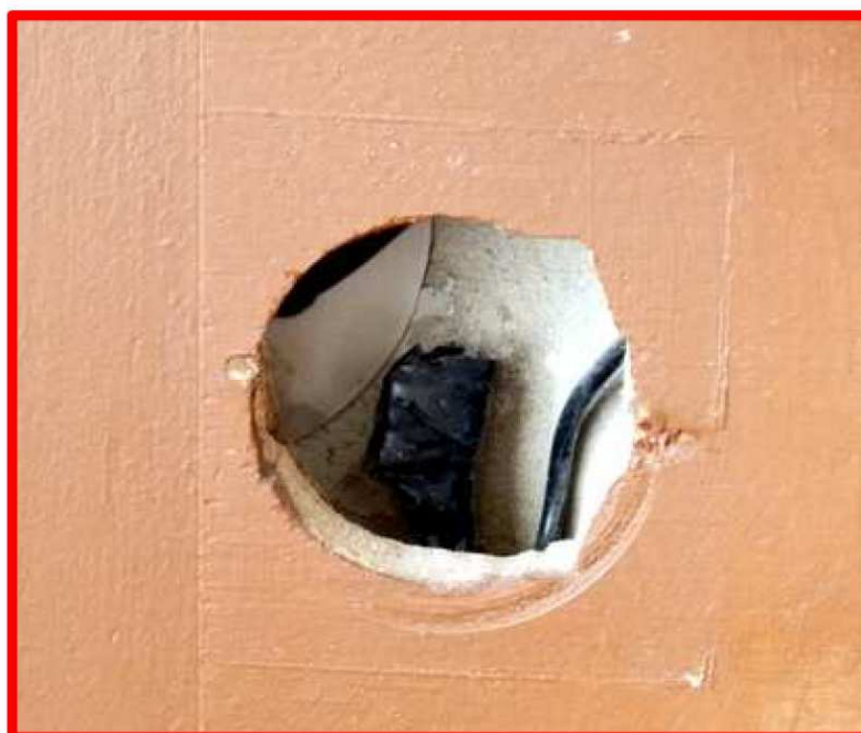
Otvor po zásuvce ve stěně pokoje
